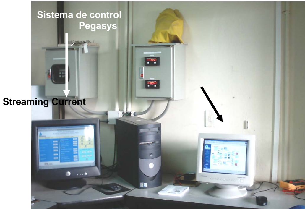
Figura 89. Cuarto de Control para Operadores
