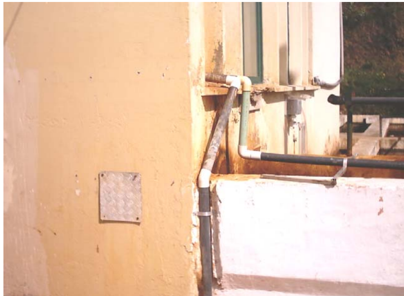
Figura 78. Tubería para direccionamiento de coagulante al punto de aplicación
