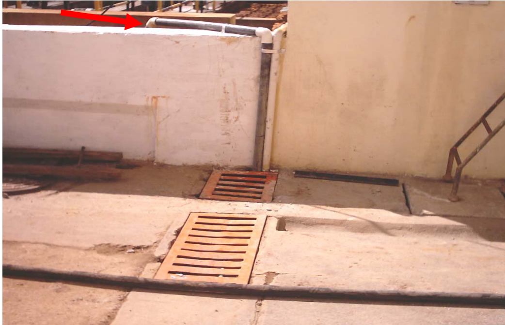
Figura 81. Punto de Dosificación Sedimentador de Placas
