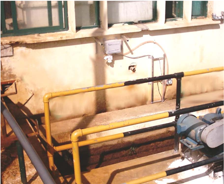
Figura 93. Sensor Sedimentador Convencional
