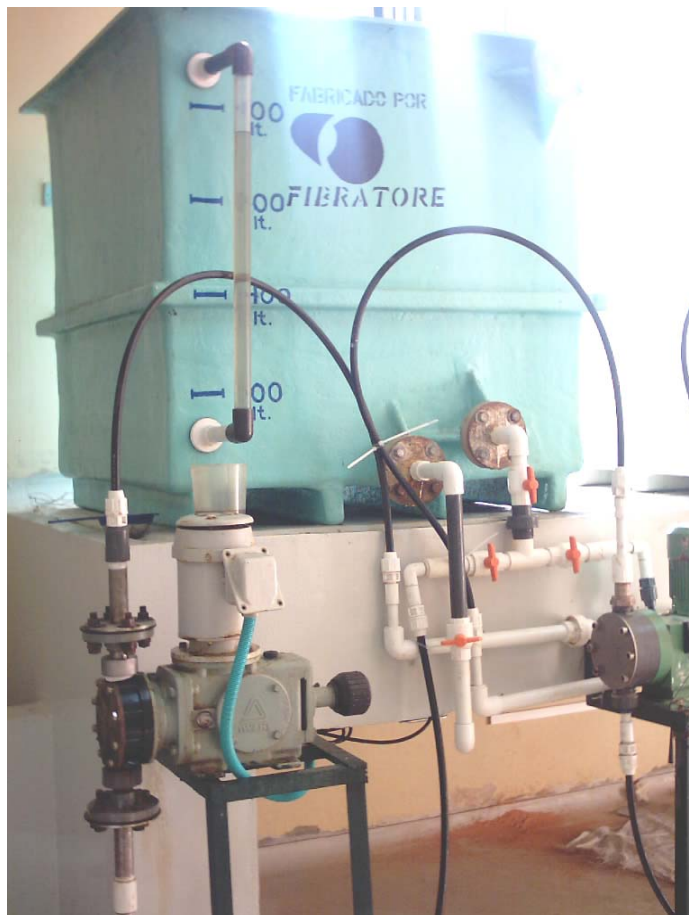
Figura 76. Tanque de Poli cloruro de Aluminio (coagulante)
