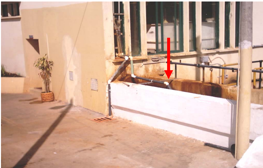
Figura 80. Punto de Dosificación Sedimentador Convencional
