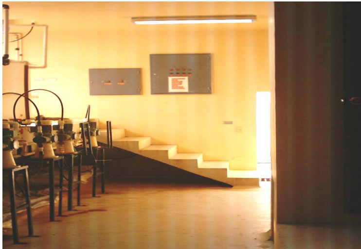
Figura 75. Cuarto de dosificación (2)
