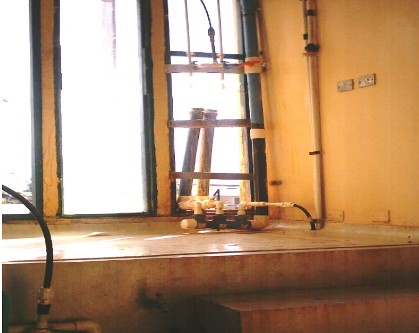
Figura 77. Cuarto de Dosificación caída de Coagulante
