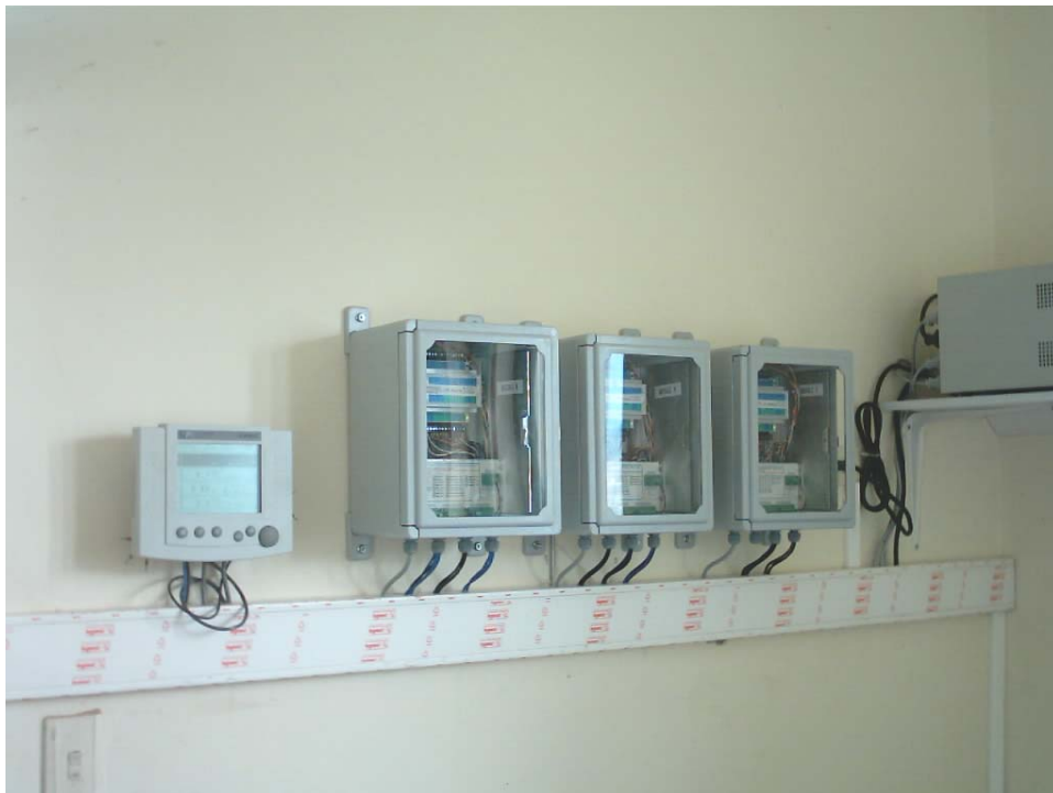
Figura 84. Tres Módulos Remotos I/O para integración de señales
