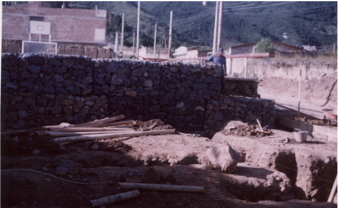
Figura 4. Muro de contención en gaviones
