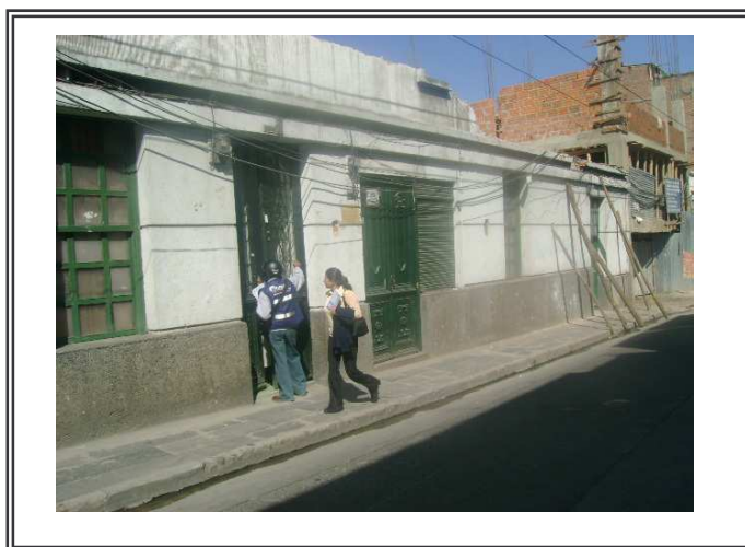
Figura 11. Desplome de Muro
