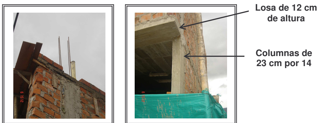
Figura 9. Construcción de vivienda sin planos aprobados
