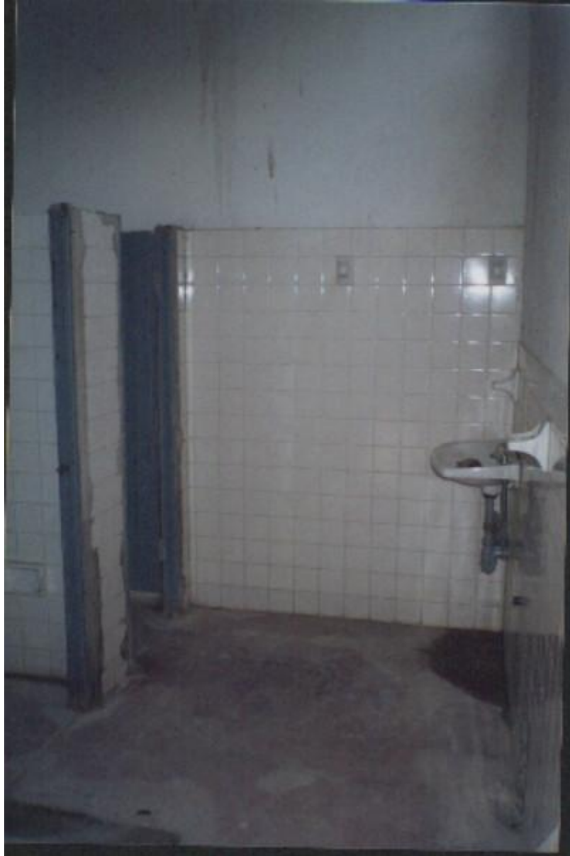
Figura 33 Estado inicial de batería sanitaria Aula múltiple
