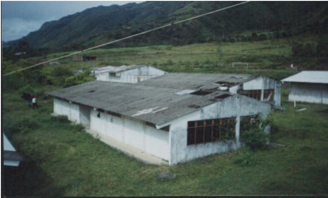
Figura 1. Estado general de las cubiertas al inicio de la obra
