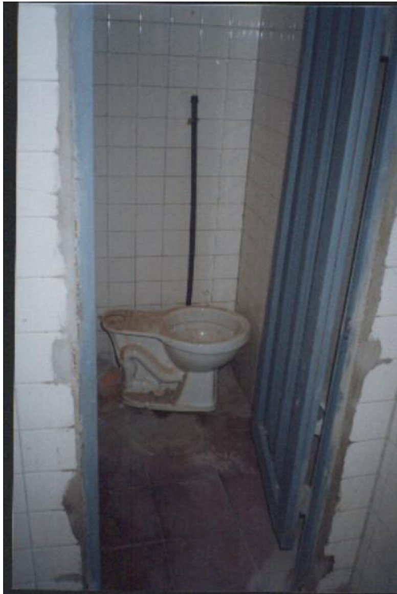
Figura 31. Aspecto inicial de batería sanitaria Bloque N° 2
