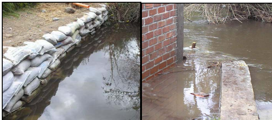
FIGURA 38.- Inconveniente de desbordamiento por protección no adecuada
