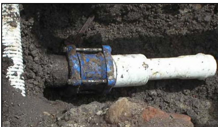
FIGURA 50.- Empalme a red principal con acople universal y reducción UZ PVC 4 x 3"
