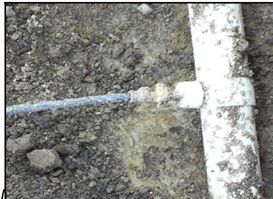
FIGURA 51.- Instalación de Acometida domiciliar con collar de derivación de 3"x1/2", registro de incorporación de 1/2" y manguera PF + UAD.
