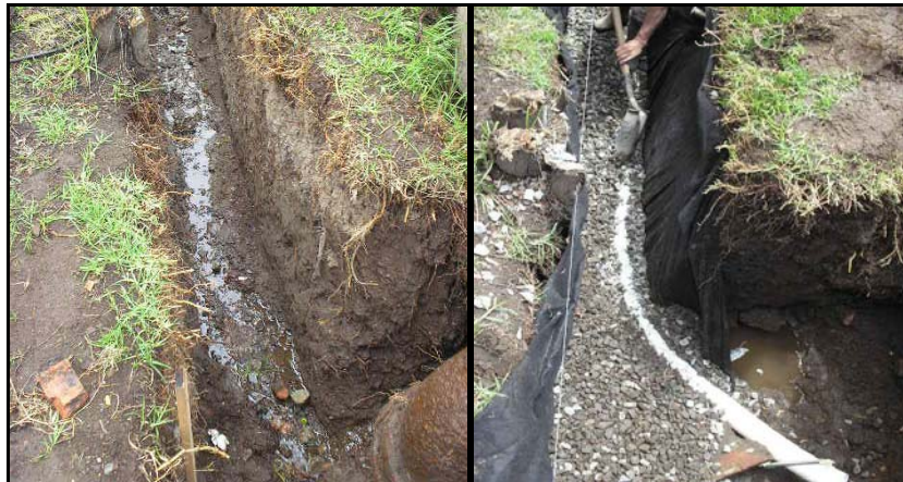
FIGURA 37.- Inconveniente y solución a nivel freático en cimentación de muro
