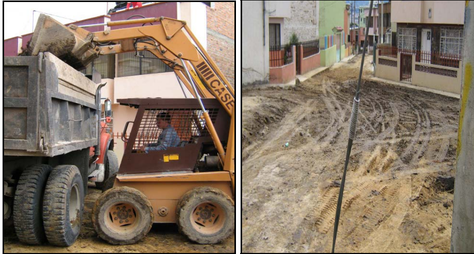
FIGURA 69.-Desalajo de material sobrante con minicargador y lugar de la obra luego de retiro de material con relleno terminado
