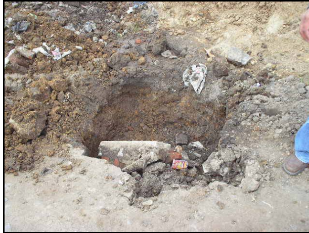
FIGURA 80.- Sumidero tapado y con estructura totalmente dañado
