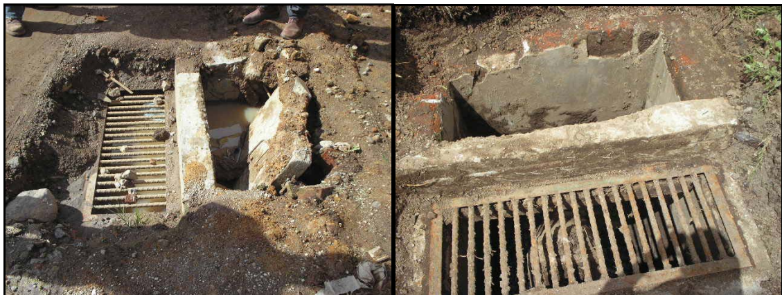
FIGURA 79.- Condiciones de los Sumideros
