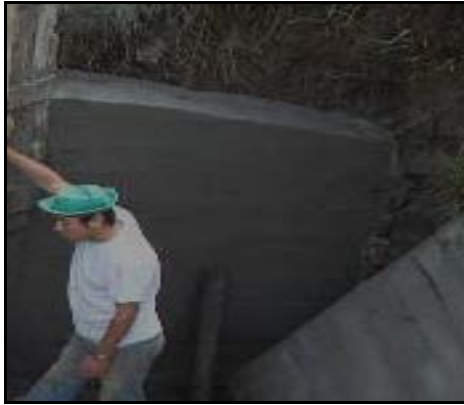
FIGURA 39.- Prolongación de la aleta.
