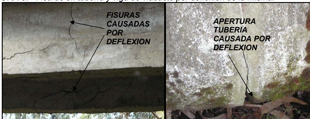
FIGURA 9.- Fisuras en tubería y viga de viaducto por deflexión de la misma.
