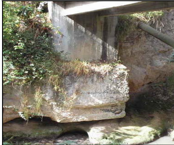
FIGURA 10.- Socavación en apoyo No. 1
