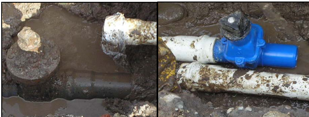
FIGURA 52.- Válvula de compuerta existente en HF vástago ascendente en mal estado y válvula instalada en Hierro Dúctil vástago no ascendente sin rueda de manejo.
