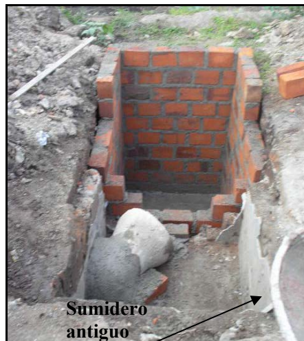
FIGURA 83.- Sumidero nuevo respecto de sumidero antiguo
