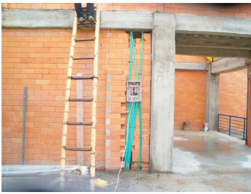
Figura 120. En el muro esta incrustado el tablero de distribución.
