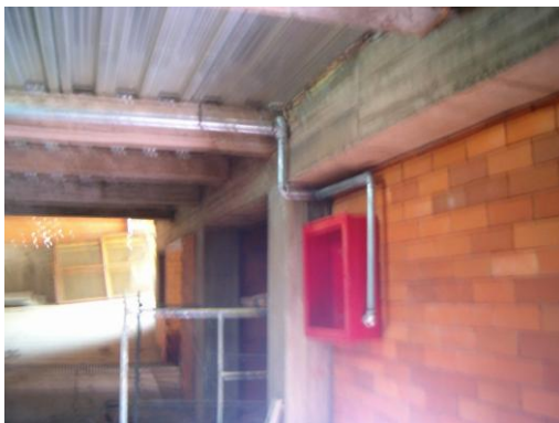
Figura 112. Instalación red contra incendios.
