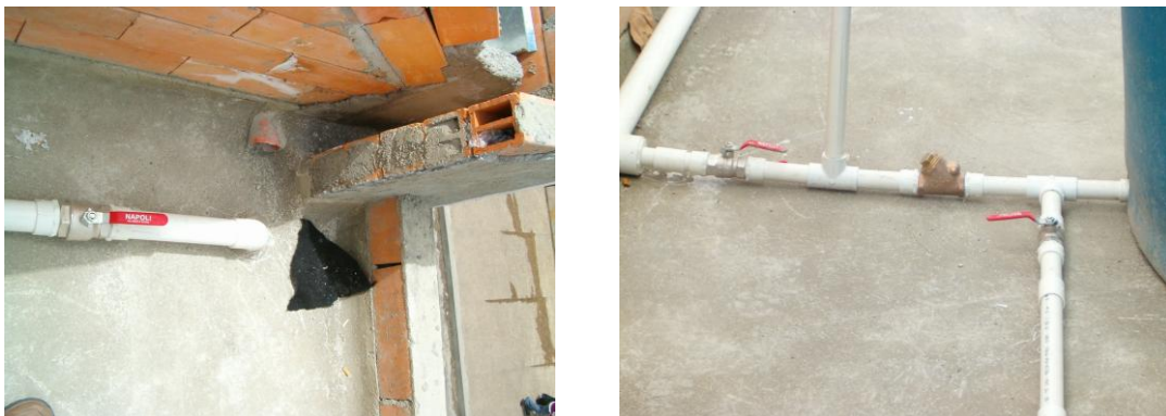
Figura 116. Válvulas de paso, cheques.
