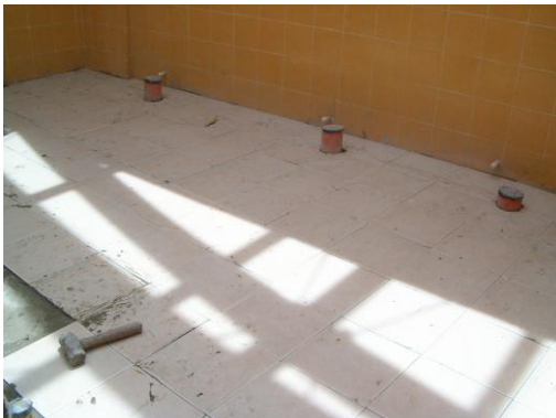
Figura 99. Tubos sanitarios tapados
