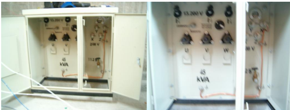
Figura 122. Vista frontal transformador de energía.
