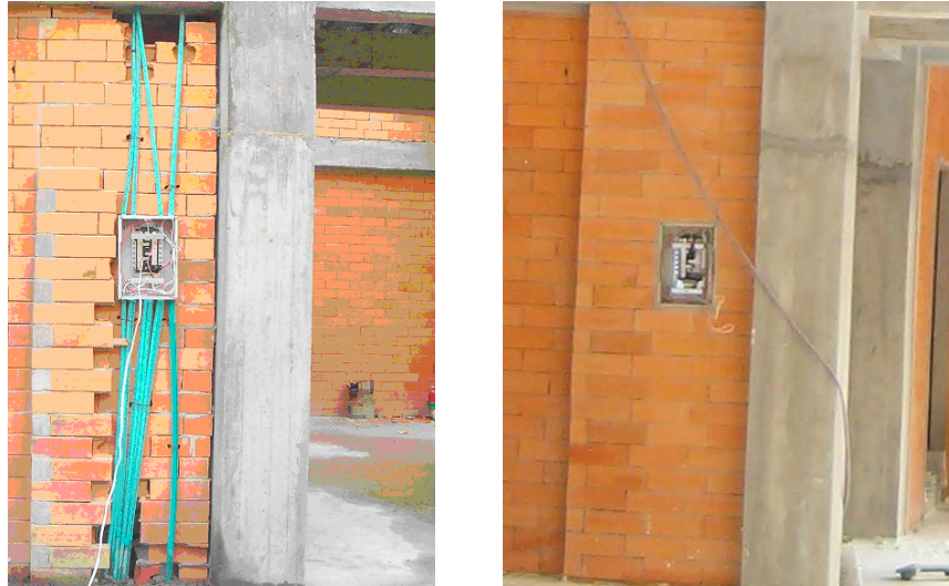
Figura 154. Tableros de control.
