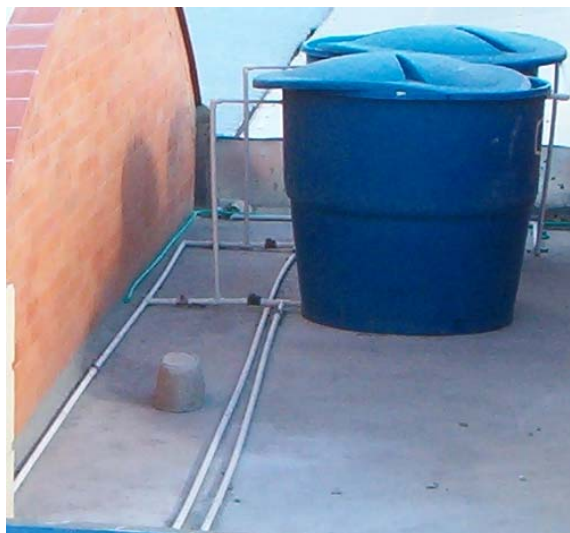
Figura 134. Instalación hidráulica de los tanques de reserva.
