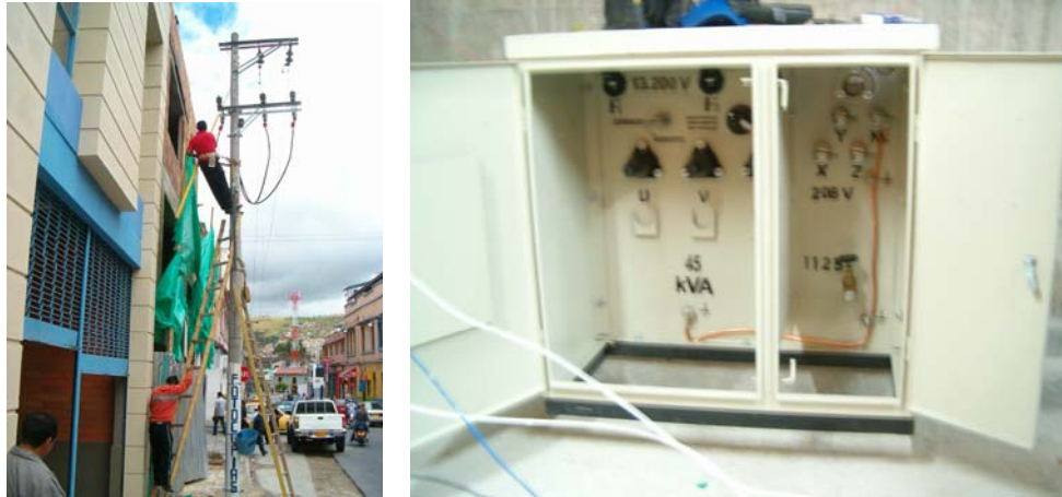
Figura 152. Acometida y subestación.
