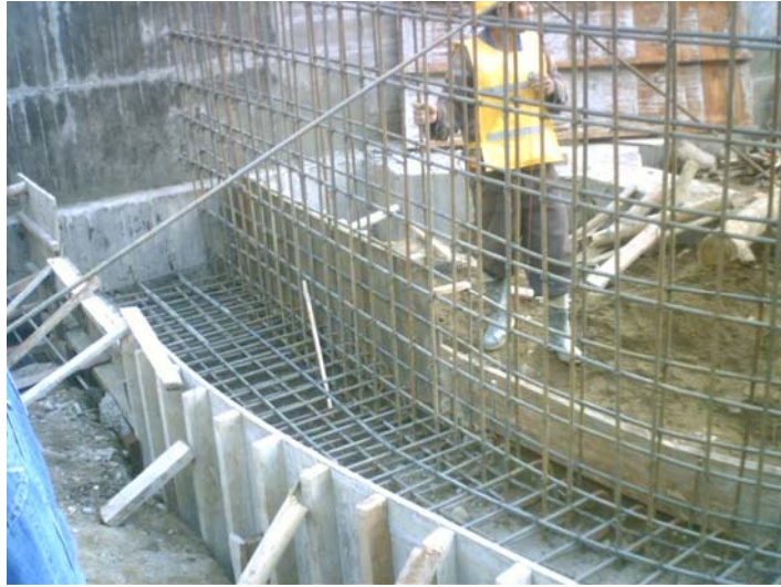
Figura 46. Refuerzo de la zarpa y del muro de contención de la rampa.
