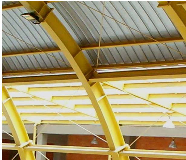
Figura 156. Luminarias metal Halaid de 400W y 250W.
