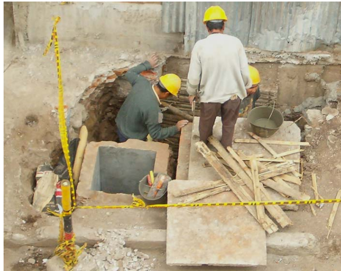
Figura 140. Cajas de inspección.
