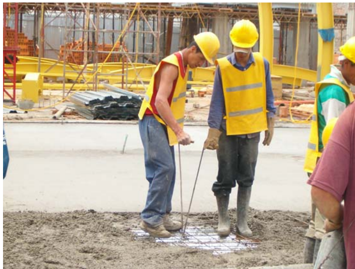
Figura 76. Fundición de losa.
