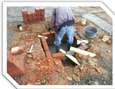
Figura 39. Cajillas de inspección
