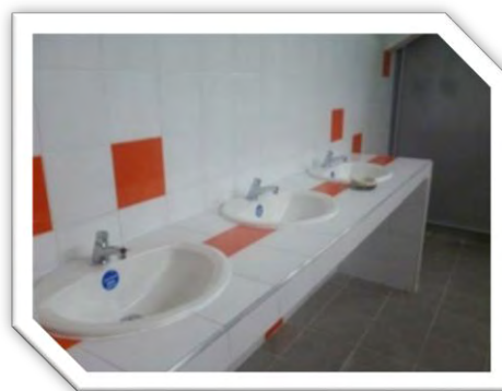
Figura 64. Lavamanos unidades sanitarias
