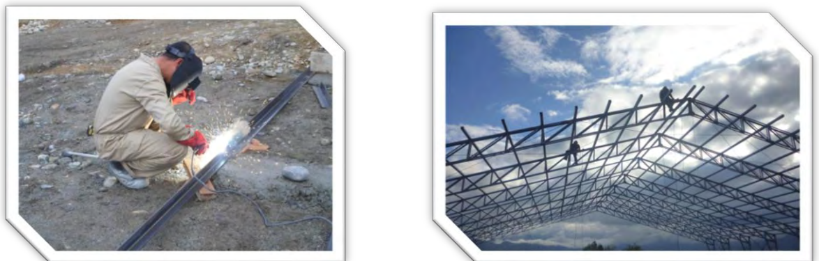
Figura 75. Uso de implemento de protección estructura metálica
