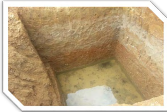
Figura 8. Saturación de agua en zapatas
