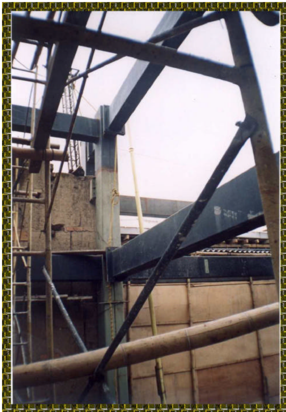
Foto 103. Montaje de dos vigas, donde una de ellas tiene doble platina, se encuentran al nivel de 14.42m
