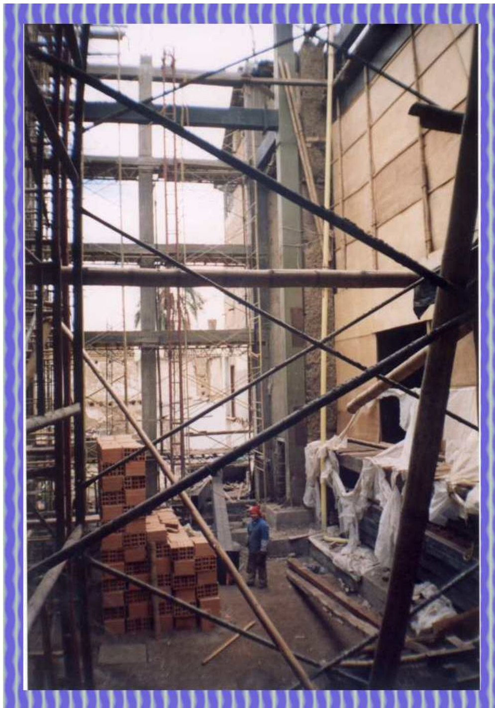
Foto 101. Montaje de dos vigas, donde una de ellas tiene doble platina, se encuentran al nivel de 11.06m
