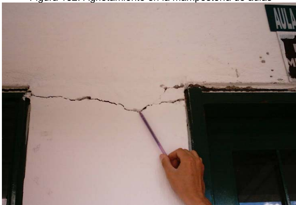
Figura 162. Agrietamiento en la mampostería de aulas
