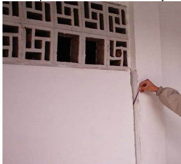
Figura 164. Desprendimiento entre el muro y la columna
