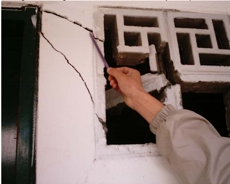
Figura 160. Agrietamiento en la estructura y mampostería
