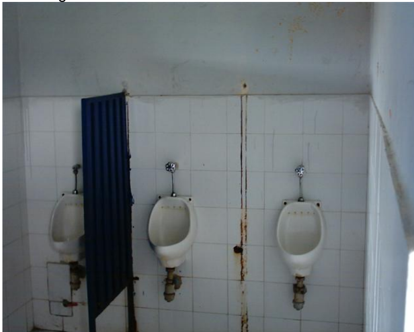
Figura 188. Estado actual de la unidad sanitaria
