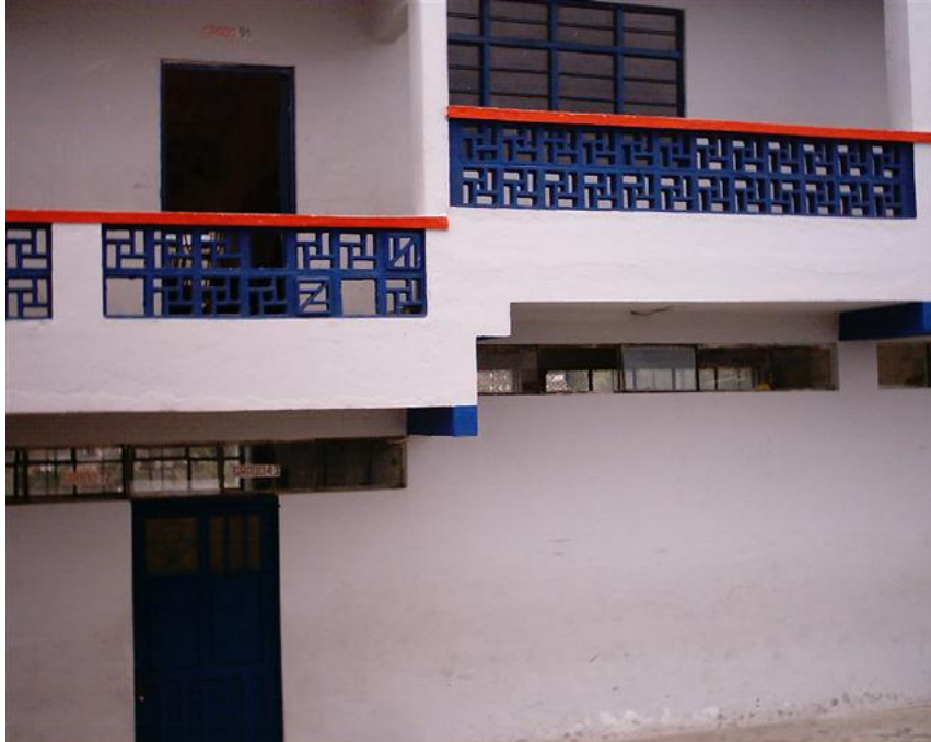
Figura 189. Problemas estructurales, diferencia de nivel entre losas
