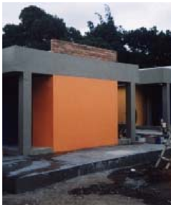
Figura 202. Nueva batería sanitaria
