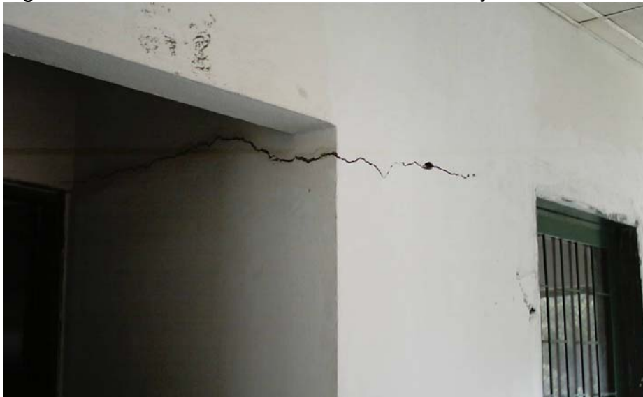
Figura 161. Daños acceso a la batería sanitaria y cuarto eléctrico
