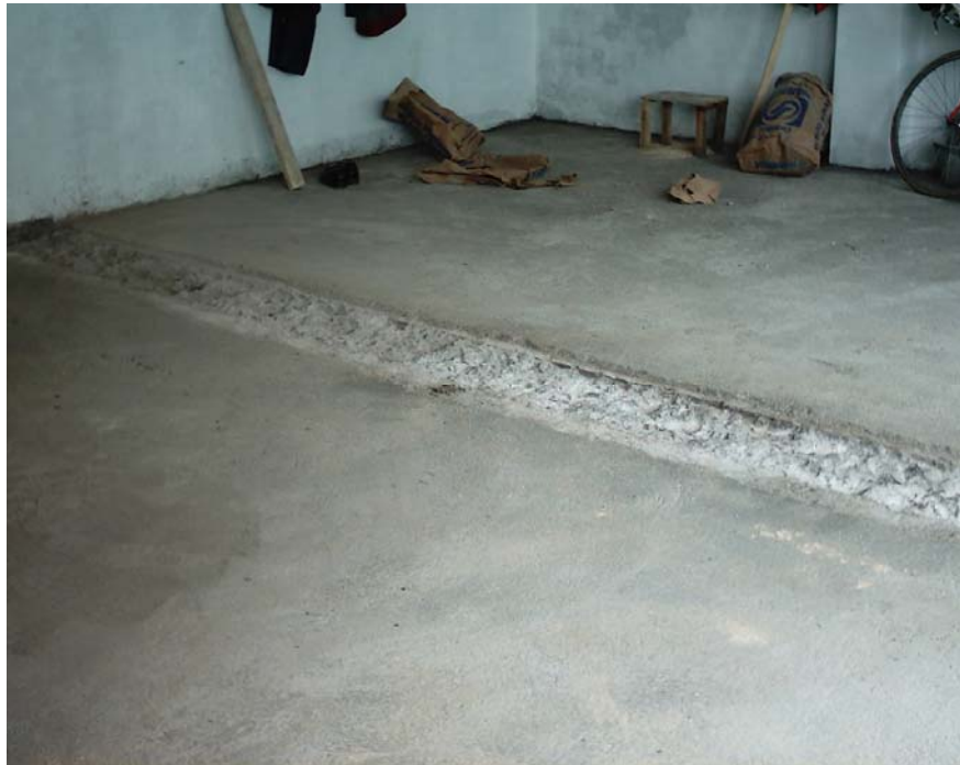
Figura 127. Viga cimentación demolida por error de contratistas
