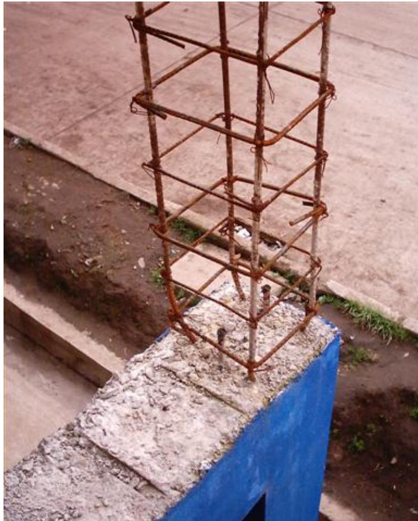
Figura 211. Insuficiente refuerzo longitudinal en la columna, excesiva separación entre estribos en el refuerzo a cortante
