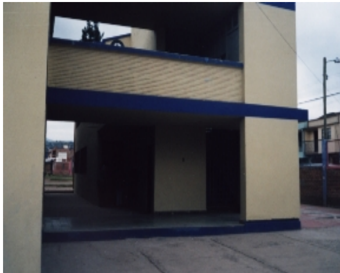
Figura 198. Bloque en riesgo
