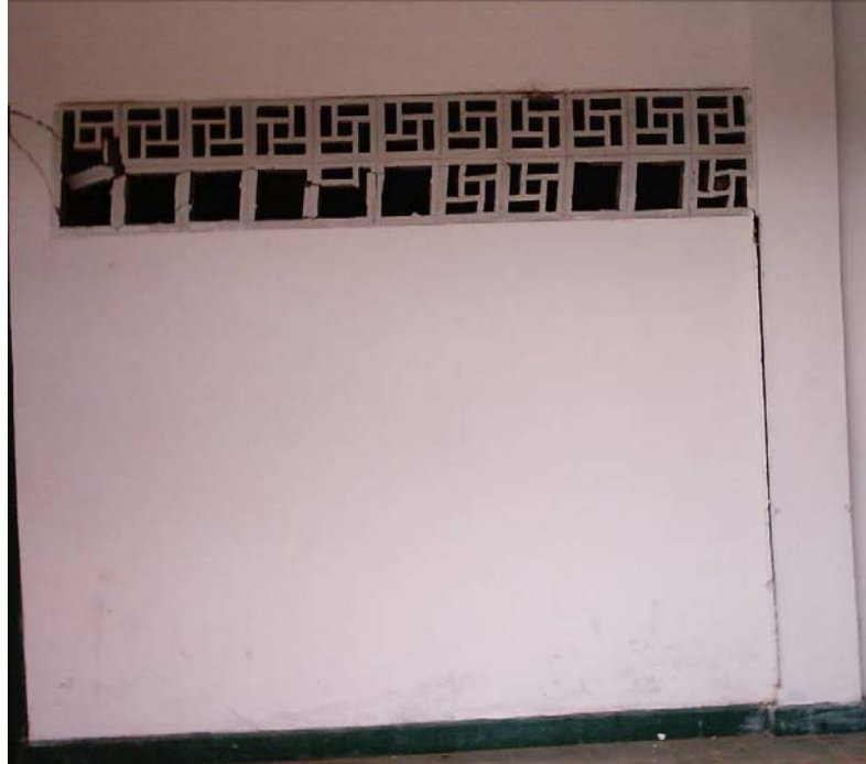
Figura 163. Desprendimiento entre el muro y la columna
