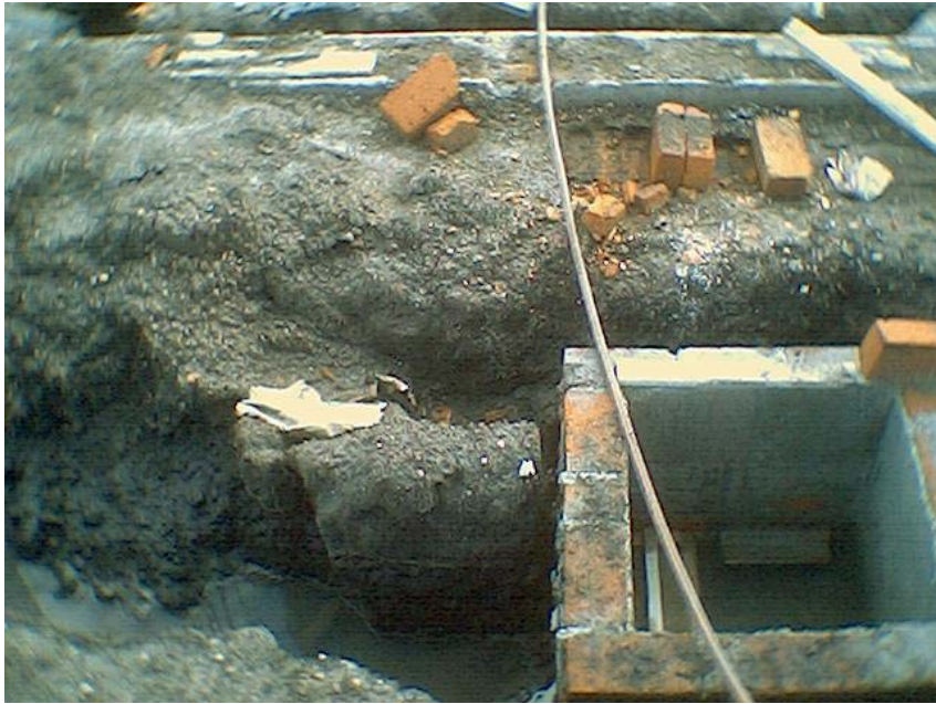
Figura 97. Vista general del eje de tubería de aguas negras en bloques 1 y 2
