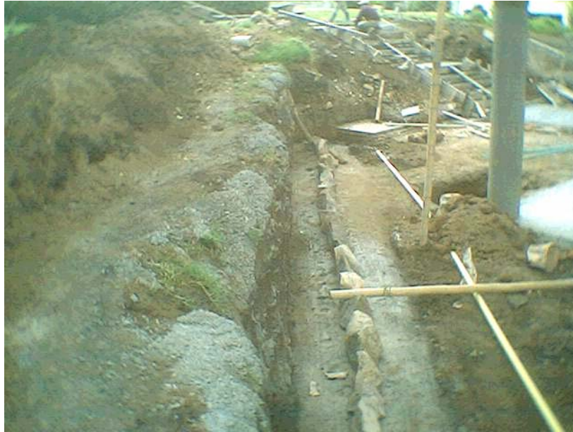
Figura 10. Problemas de deslizamiento
