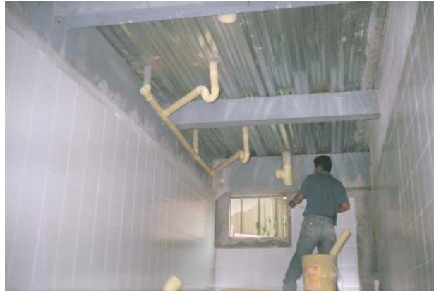
Figura 110. Instalación sanitaria baño segundo piso
