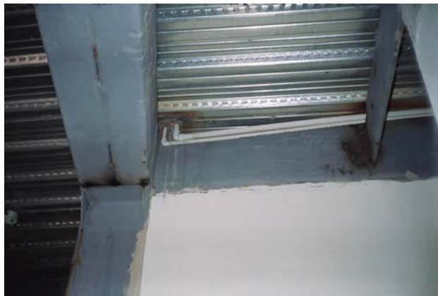
Figura 106. Tubería hidráulica de alimentación del tanque de reserva
