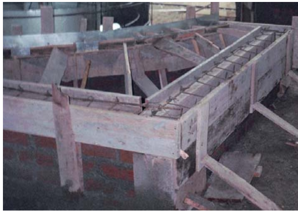
Figura 133. Armado y formaleta de cintas de amarre y alfajía interna en jardineras
