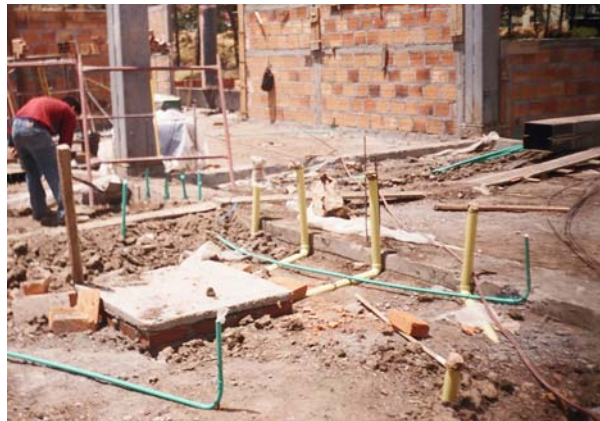
Figura 41. Tubería eléctrica, sanitaria y cajas de inspección en baño.
