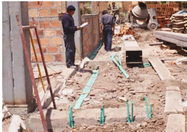
Figura 115. Ductería eléctrica en primer piso
