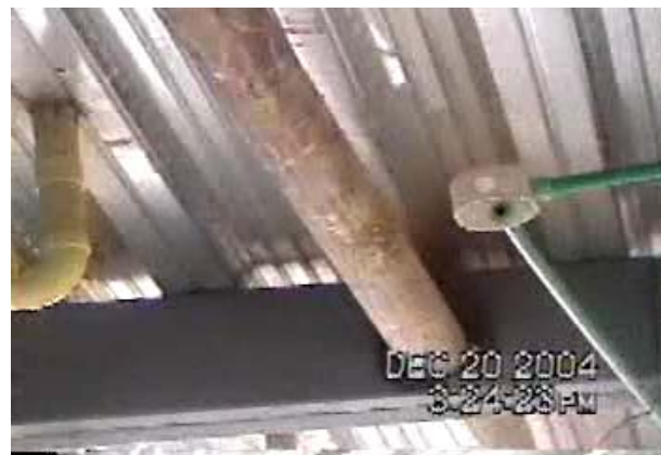
Figura 111. Detalle de perforación en vigueta de entrepiso
