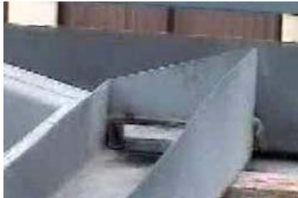
Figura 88. Empalme entre canaletas metálicas perpendiculares
