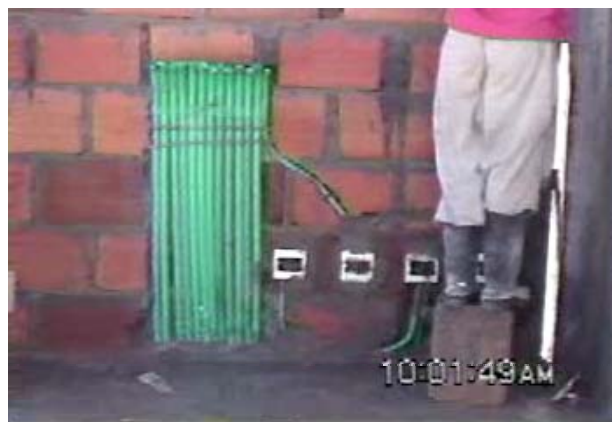
Figura 117. Ductería y cajas eléctricas voz y datos
