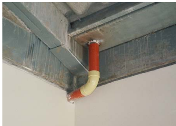
Figura 113. Conexión desde la canaleta al bajante de aguas lluvias
