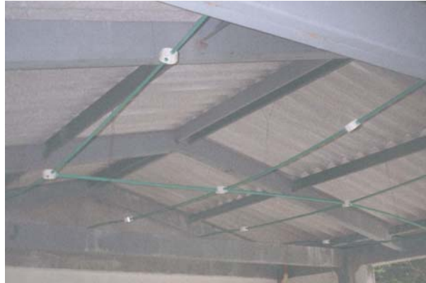
Figura 118. Ductería y cajas de iluminación
