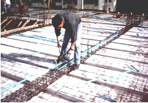
Figura 76. Conexión a caja de inspección.
