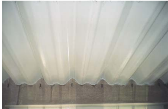
Figura 45. Canaleta 90 totalmente húmeda
