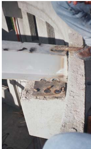
Figura 37. Corte de los pernos de las platinas en las Ménsulas del Bloque Circular
