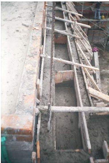
Figura 16. Presentación final al terminar el vaciado del concreto en las vigas canal
