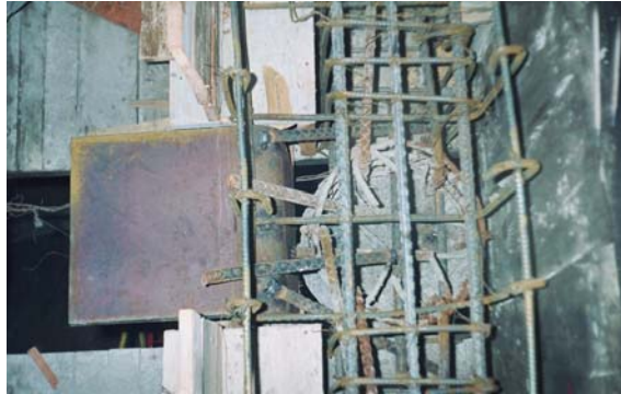
Figura 36. Platina soldada a los hierros de la viga canal y columnas (Bloque 5)
