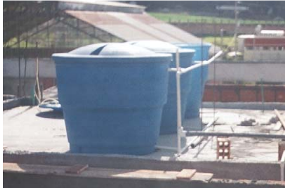
Figura 57. Conexión de los tres Tanques de Almacenamiento
