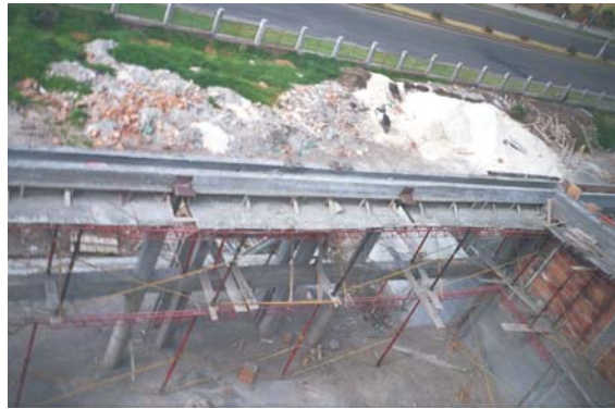
Figura 19. Desencofrado de laterales de la viga canal y esmaltado de su parte interna
