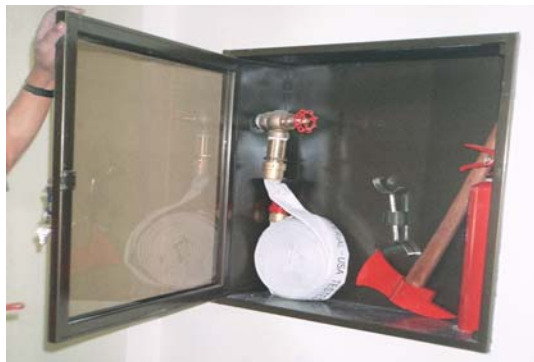
Figura 58. Gabinete Contra Incendios instalado
