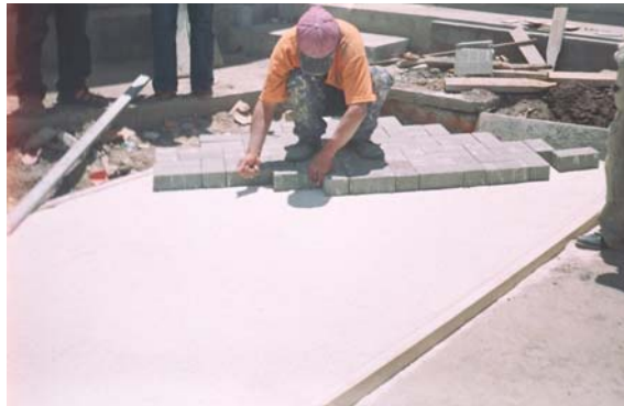
Figura 118. Instalación de adoquín, en el cual se puede observar la base, la capa de arena y los adoquines
