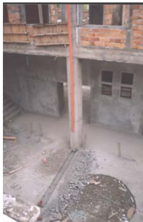
Figura 55. Tubería de aguas lluvias que será conectada con una tubería horizontal que conducirá las aguas a un sifón y de éste a una caja de inspección
