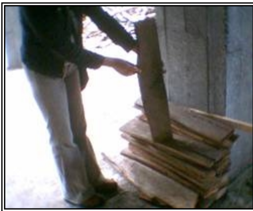
Figura 5. Madera de casetón en mal estado.
