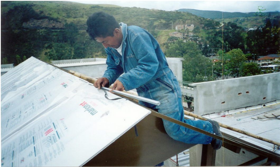
Se instala un perfil de aluminio en U con un caucho con el fin ejercer presión en la lamina para tapar las aberturas de la parte superior de la lamina, debido a las posibles filtraciones internas de agua.
