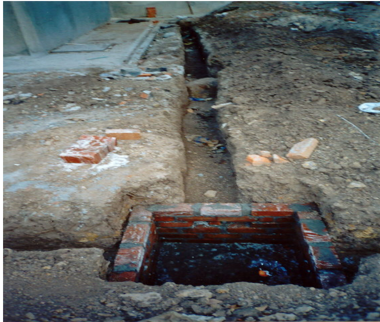
Caja de inspección de 0.8 m * 0.8 m * 0.6 m para acometida telefónica.
