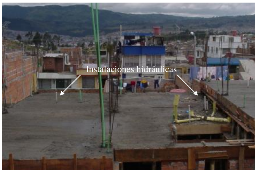
Figura 32. Instalaciones hidráulicas entrepiso
