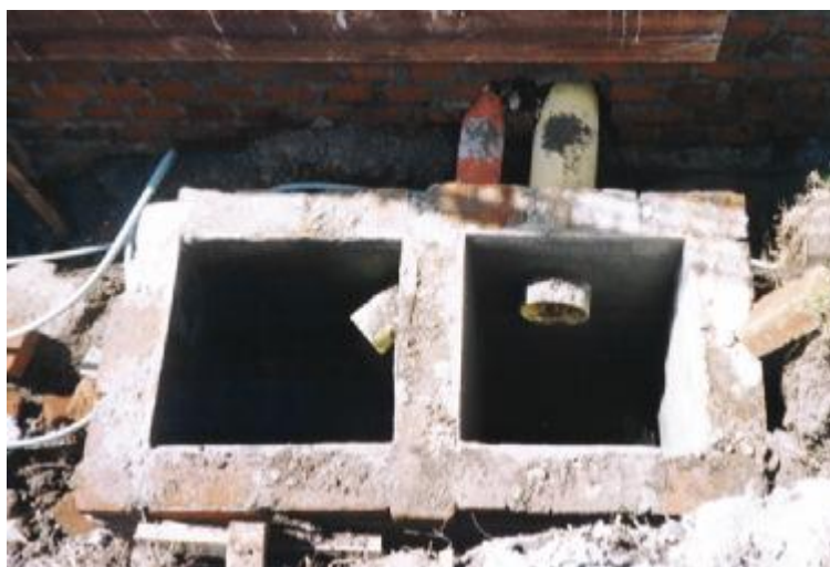
Figura 29. Cajas de inspección principales
