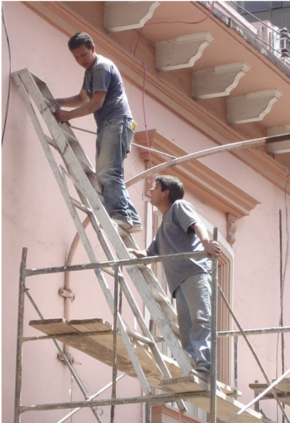
Figura 32: Obreros en situación de riesgo
