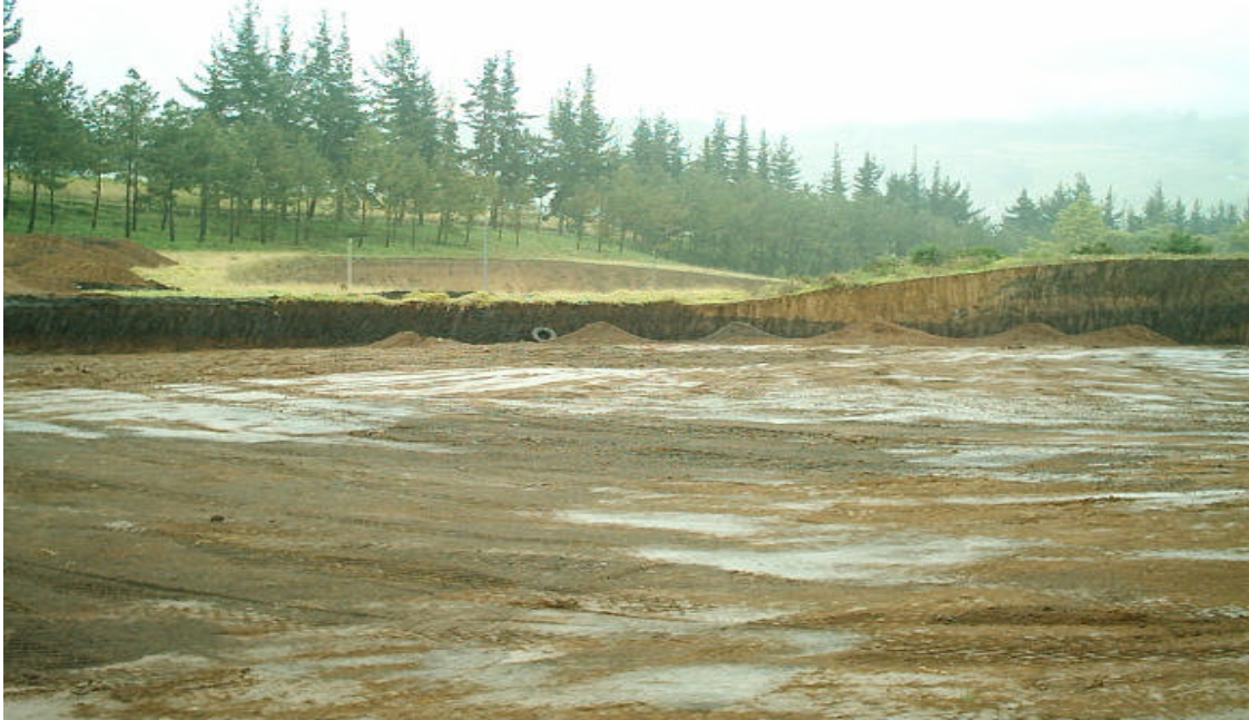
Figura 15. Condiciones del terreno bajo lluvia
