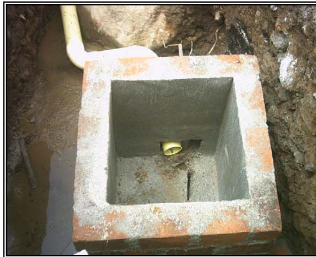
Figura 117. Caja de inspección 0,6m * 0,6m.
