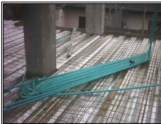
Figura 103. Ductos eléctricos instalados.
