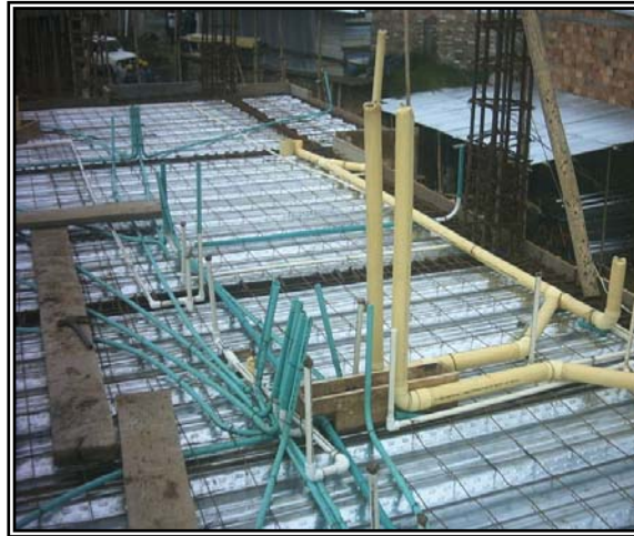
Figura 136. Instalaciones eléctricas segundo nivel.
