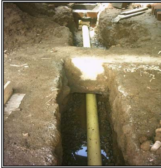
Figura 120. Ubicación tubería del filtro.
