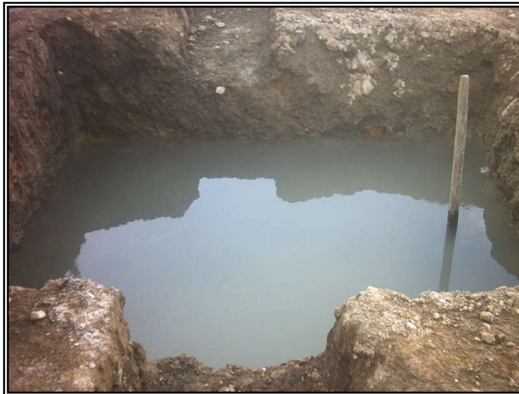
Figura 35. Presencia de Nivel freático.
