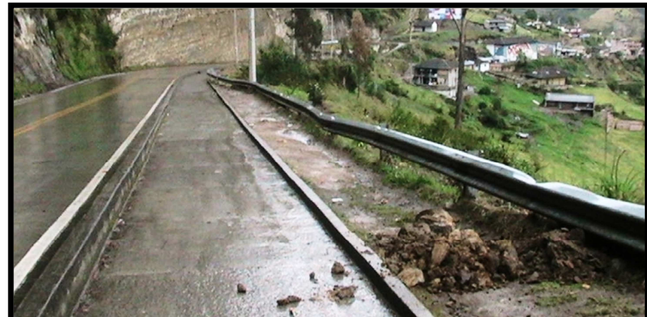
FOTO N° 21 : Estado Vía peatonal. A Las Lajas. FUENTE: Trabajo de Campo.
