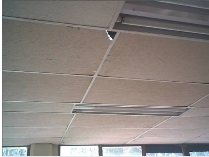
Figura 44. Materiales en mal estado
