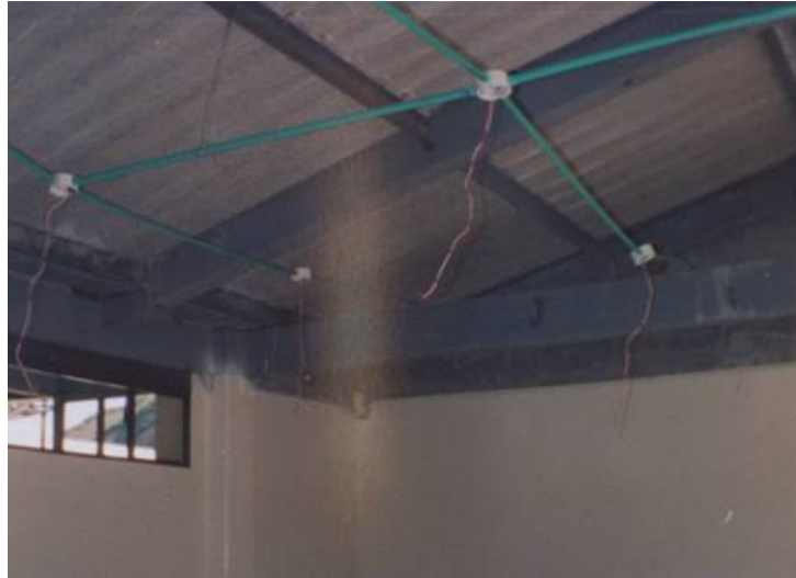
Figura 26. Cableado de aparatos eléctricos
