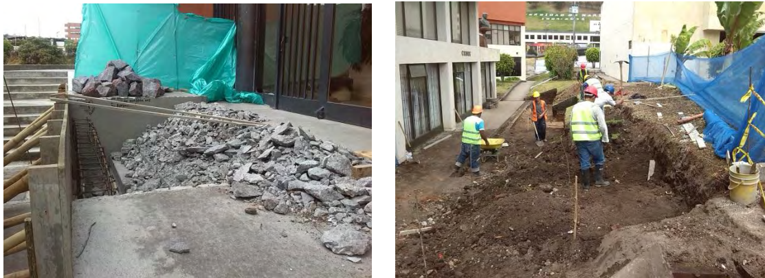
Figura 2.21. Demolición de escaleras en el bloque de Derecho y en frente de la Biblioteca.
