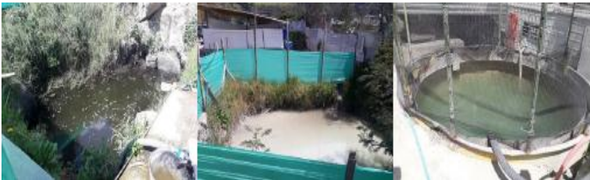
Figura N° 7: Pozo 1 / Pozo 2 / Tanque producción
