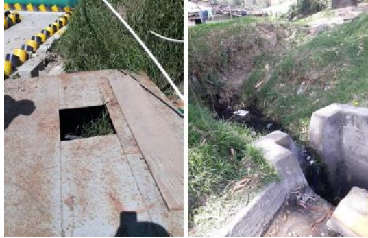
Figura N° 9: Tanque séptico / ARD - Alcantarilla
