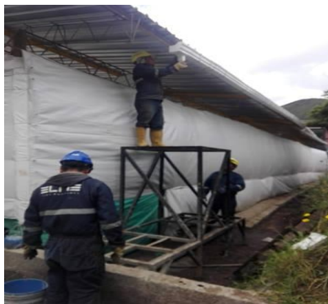
Figura N° 19: Instalación de los canales recolectores de agua Lluvia/ Base metálica (soporte del sistema)
