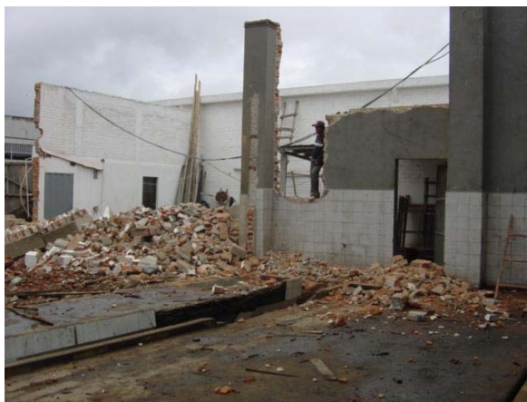
Figura 40. Demolición sin Licencia
