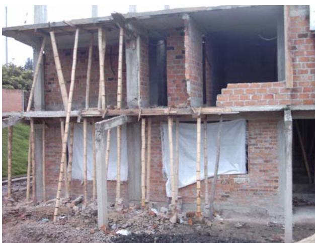
Figura 38. Construcción sin planos aprobados o construir sin licencia
