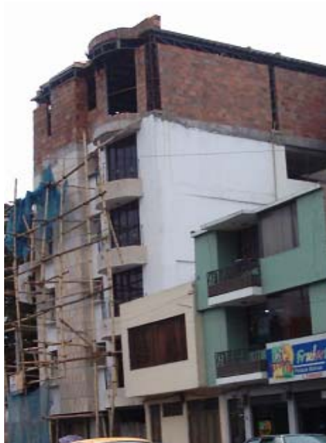
Figura 37. Construcción no ceñida a planos
