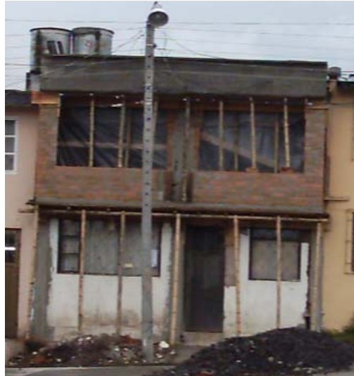
Figura 39. Construcción sin responsable de la obra
