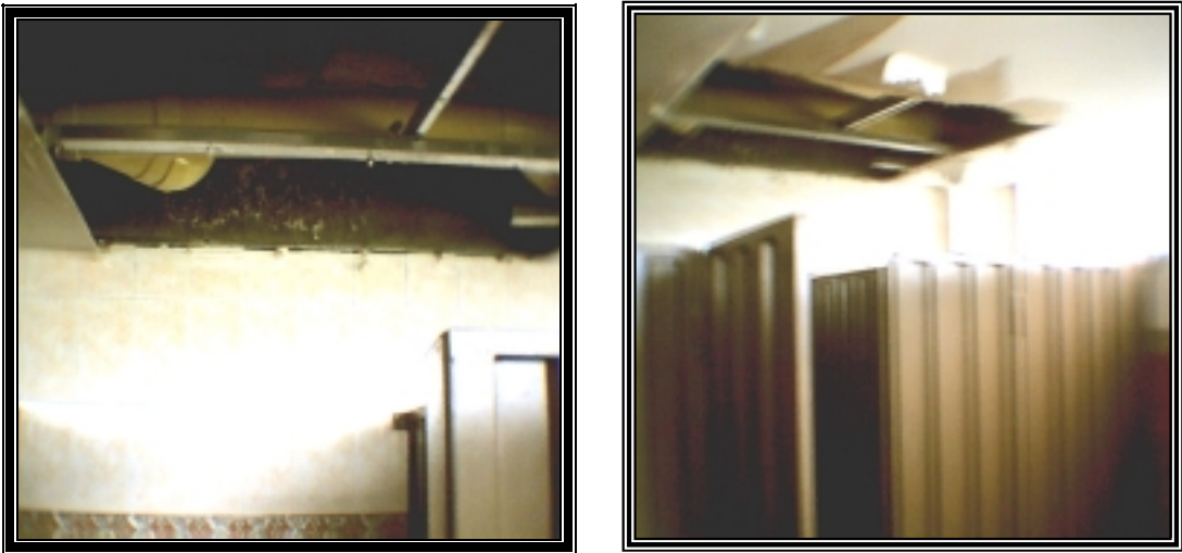
Figura 3. Deterioro del Cielo Raso de baños Facultad de Ingeniería, causado por filtraciones de agua.
