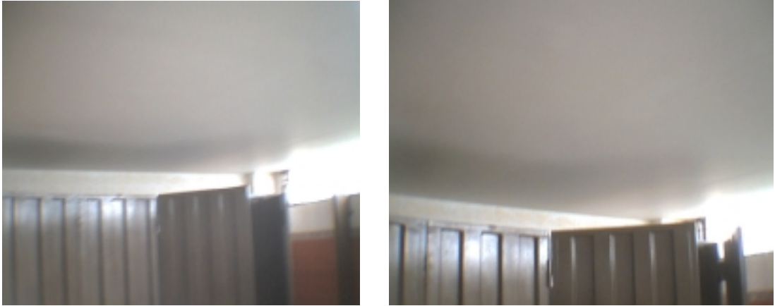
Figura 4. Estado Actual del Cielo Raso de baños Facultad de Ingeniería.
