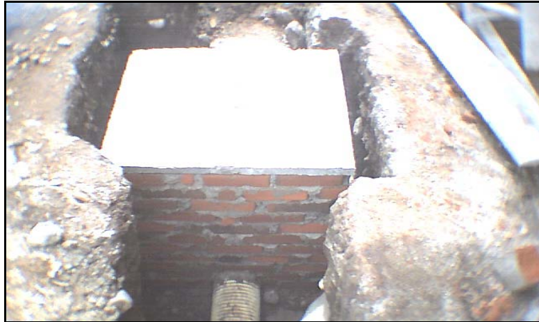
Figura 74. Caja de inspección con tapa
