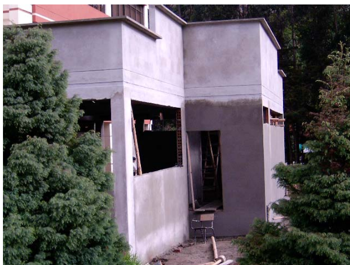
Figura 53. Muro exterior con estrías
