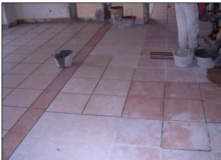
Figura 100. Cambio de piso deteriorado.
