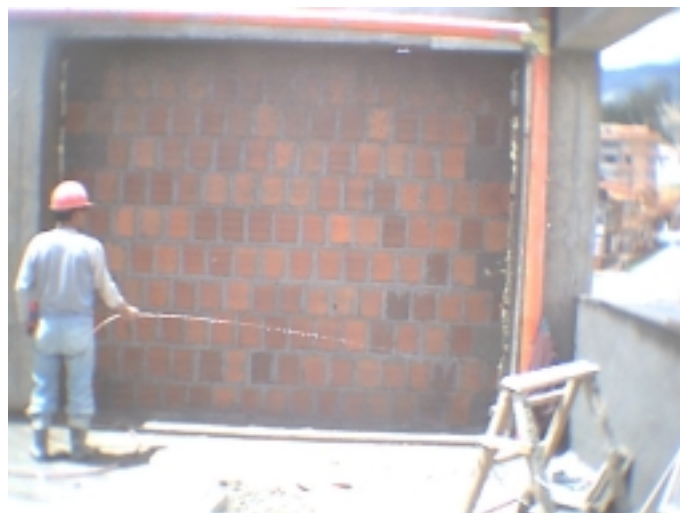
Figura 63. Humedecimiento de muros.
