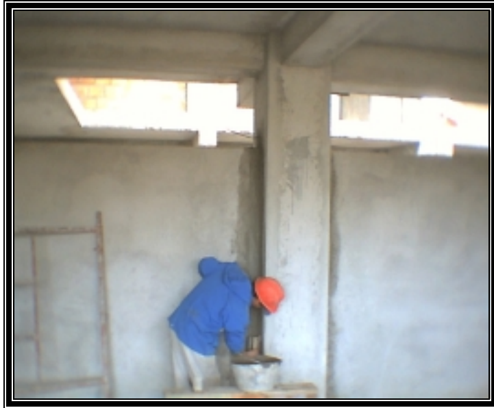
Figura 69. Estrías de muros interiores.
