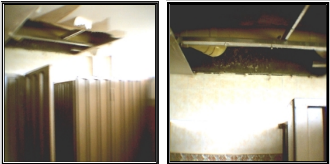
Figura 110. Estado de las unidades sanitarias.
