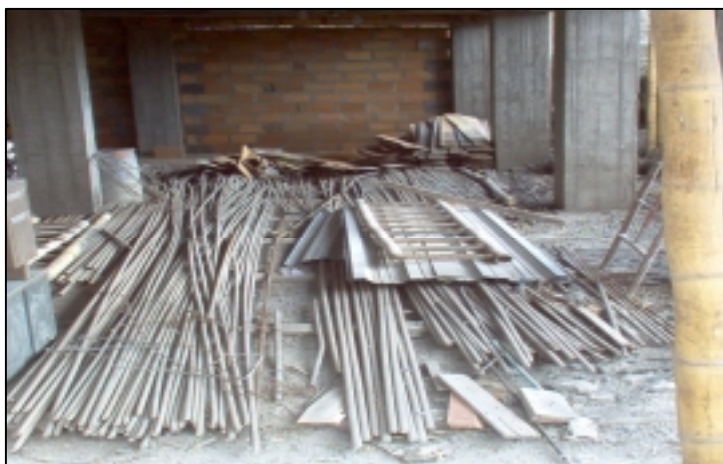
Figura 7. Almacenamiento de hierro bajo techo.
