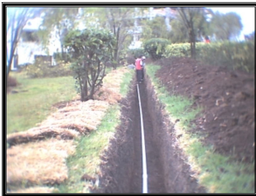
Figura 87. Acometida agua potable.
