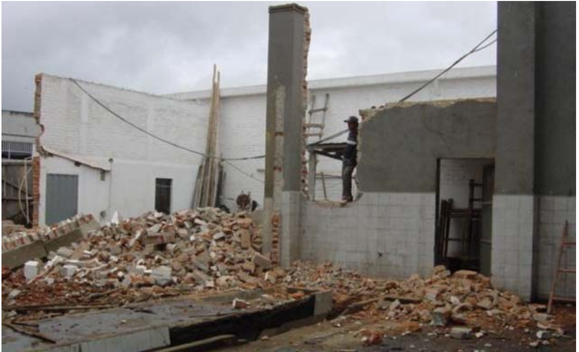
Figura 4. Demolición sin licencia.
