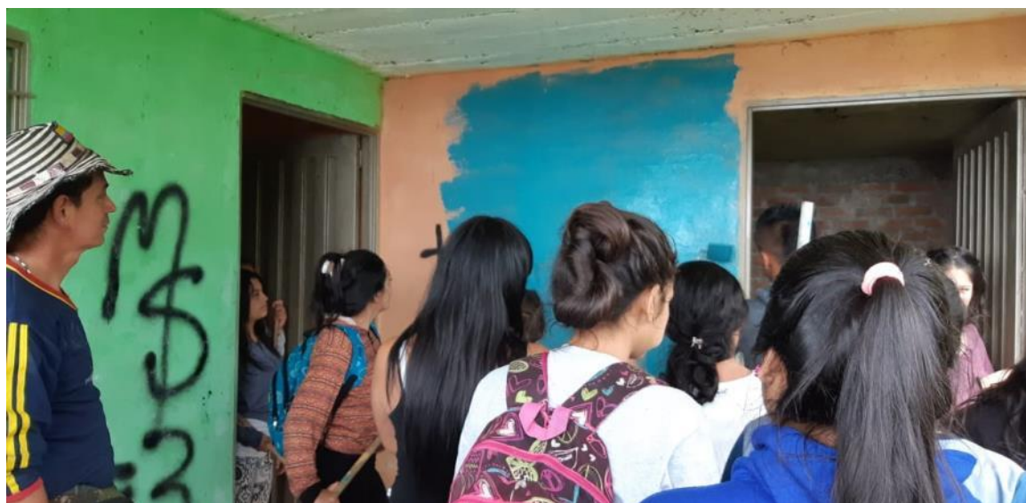
Ilustración 14: Cabaña de la reserva Alto Dalmacia, deteriorada y llena de grafitis.
