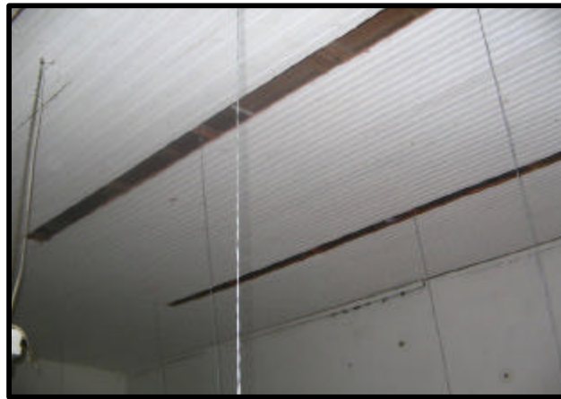
Figura 28. Estado inicial de las aulas.
