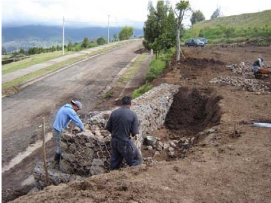
FIGURA 40.- Muro en gaviones parte inferior. Vía vehicular y peatonal para el acceso a la pista.
