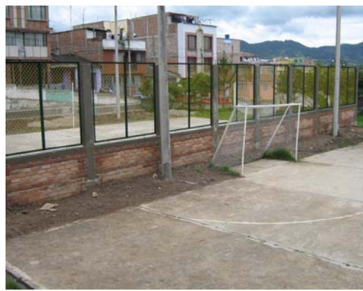
FIGURA 88.- Cerramiento de protección terminado, visto desde la cancha de micro fútbol, detrás de cerramiento se encuentra cancha de volleyball.
