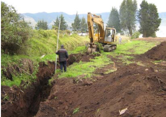
FIGURA 34.- Excavación de zanjas a maquina parte lateral derecha del lote (vista desde acceso)
