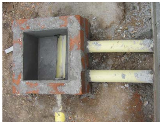
FIGURA 145.- Caja de derivación de las instalaciones sanitarias.
