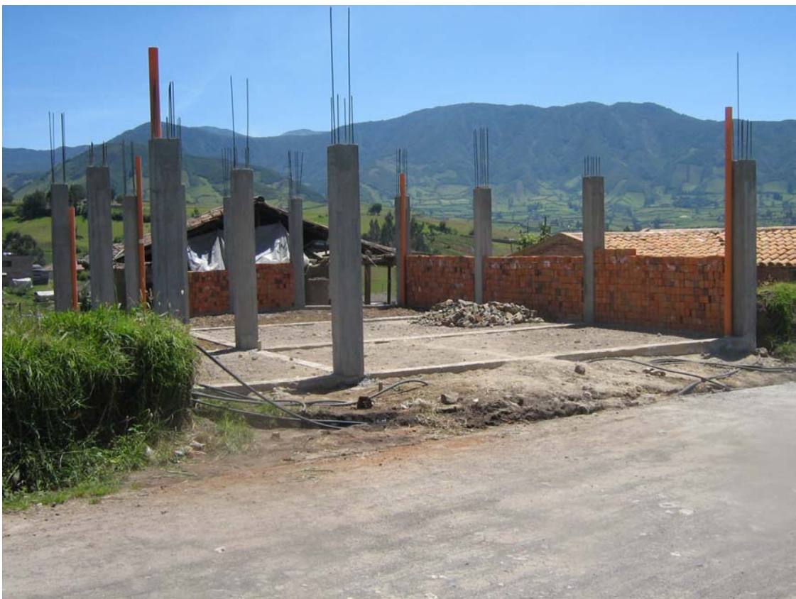
FIGURA 149.- Columnas fundidas en concreto, base en recebo compactada para piso. Vista frontal salón cultural.
