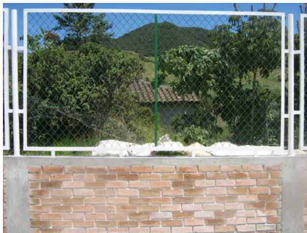
FIGURA 122.- Detalle del cerramiento de protección
