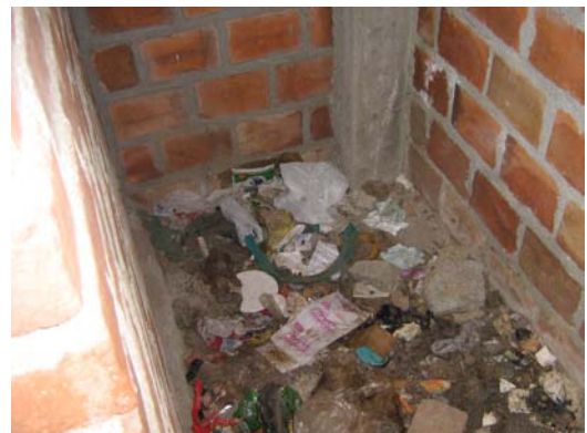
FIGURA 126.- Estado inicial del salón cultural, vista interior en los baños.
