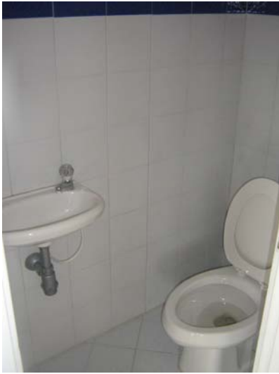
FIGURA 142.- Aparatos sanitarios en los baños.
