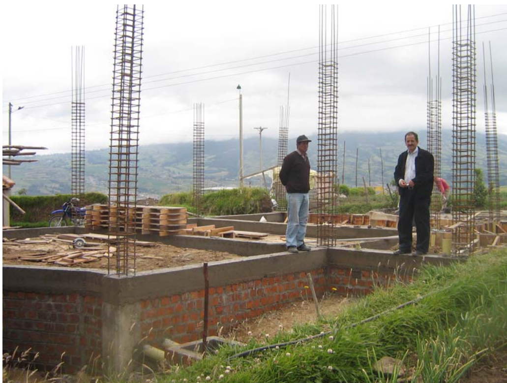
FIGURA 148.- Muro de contención en ladrillo, relleno en material seleccionado, vigas de cimentación y acero de refuerzo de columnas. Parte posterior del salón cultural.
