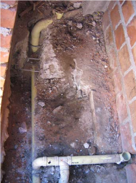
FIGURA 129.- Deterioro de las redes sanitarias, vista interior en los baños.
