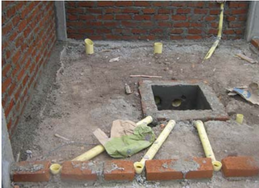
FIGURA 114.- Instalaciones sanitarias costado derecho de la batería sanitaria, baños para hombres.
