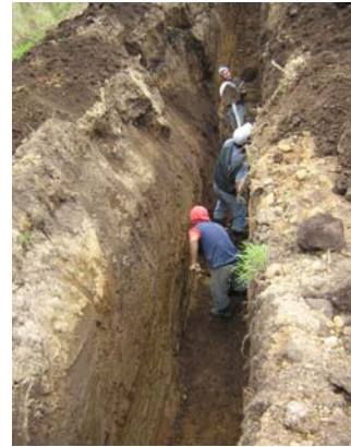
FIGURA 35.- Excavación manual de zanjas parte lateral derecha del lote (vista desde acceso)
