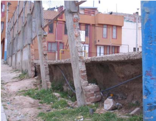
FIGURA 2.- Estado inicial del polideportivo.
