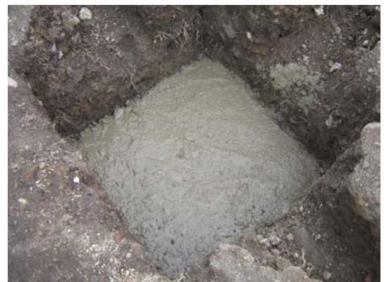
FIGURA 112.- Solado en concreto pobre en la excavación para zapata ubicada en el extremo superior izquierda.
