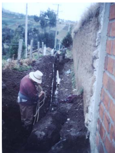
FIGURA 133.- Excavaciones de zanjas, instalación de tubería sanitaria de 4" de PVC y relleno de zanjas con material proveniente de excavación.
