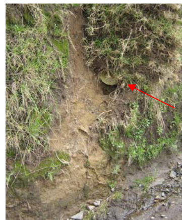
FIGURA 104.- Descole de la tubería
