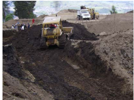
FIGURA 43.- Acarreo de material con buldózer y posterior compactación utilizando la misma maquina.
