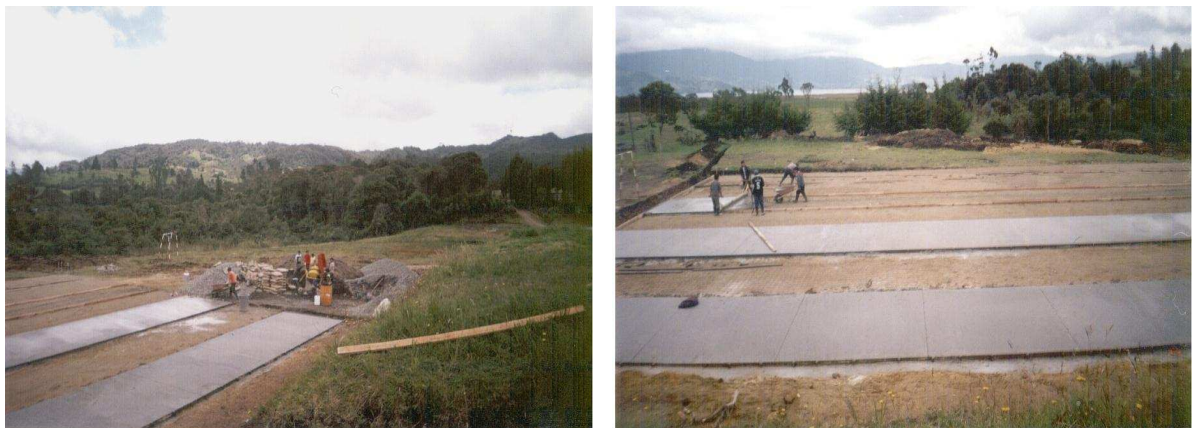
Figura 24 En las gráficas se observa la base en recebo, el enrielado y la fundición de la placa en concreto realizando paños de 3 m de ancho y largo 30 m.
