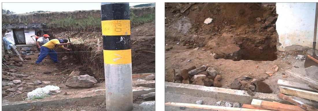
Figura 39 Excavación manual para zapatas de la puerta de acceso y el muro de contención
