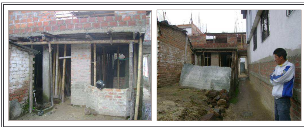
Figura 15. Construcción de sin licencia
