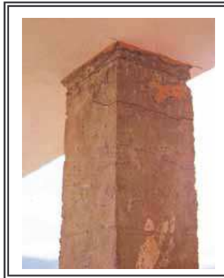
Figura 18. Fisuras por flexión en columna
