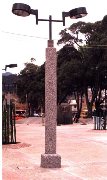
Foto 41. Luminaria Peatonal. Avenida Santander.
