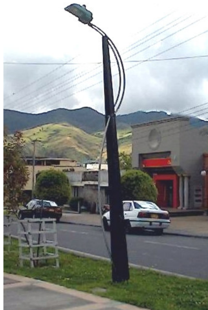
Foto 42.. Luminaria Peatonal. Avenida los Estudiantes.
