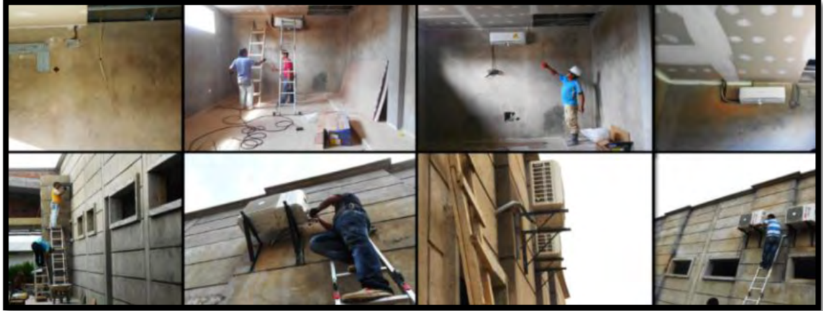
Figura 39. Instalación de aire acondicionado en el bloque de alojamiento.
