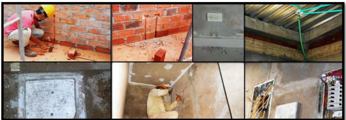
Figura 33. Instalaciones eléctricas del bloque de alojamiento.
