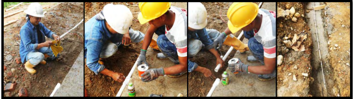
Figura 30. Instalaciones hidráulicas del restaurante escolar.
