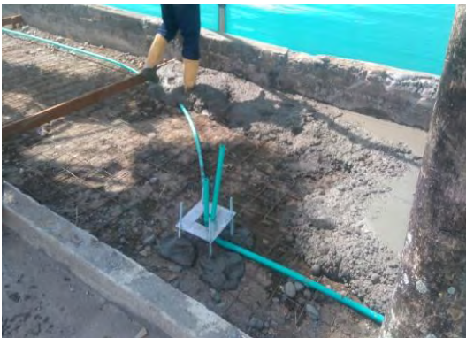
Foto 58. Base para poste de luminaria
