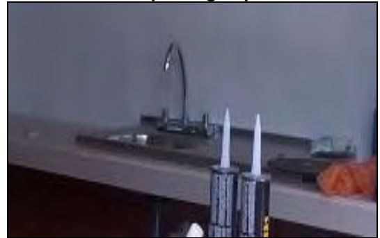
Foto 65. Salida para agua potable
