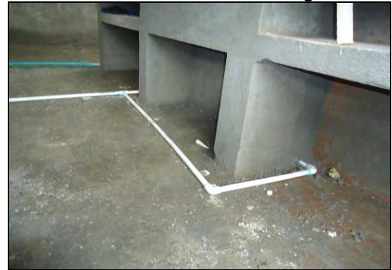
Foto 22. Red de distribución de agua
