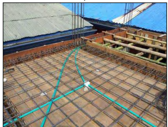
Foto 26. Tubería para salida
