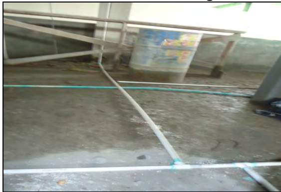
Foto 21. Red de distribución de agua
