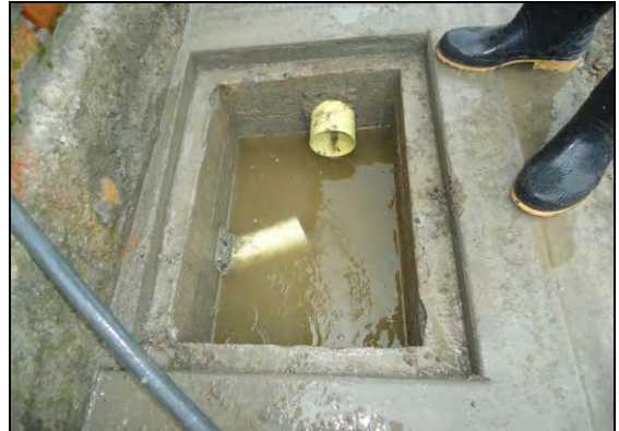
Foto 24. Caja de inspección
