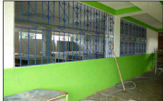
Foto 30. Protectores en varilla cuadrada
