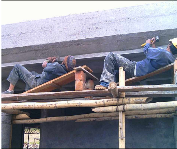
FIGURA 22. Abusardado de viga canal bloque 2
