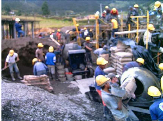
FIGURA 20. Fundición losa aligerada con tres frentes de trabajo y supervisión de la fundición del Bloque 3
