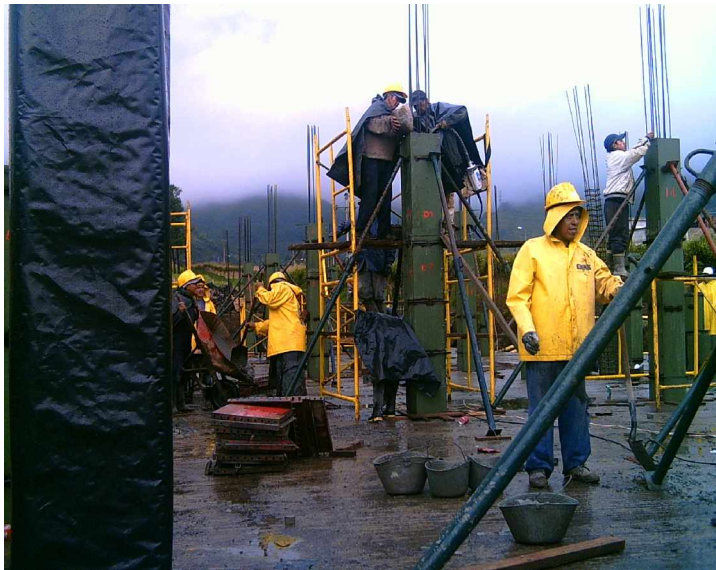
FIGURA 17. Fundición de columnas del Bloque 2, se utiliza formaleta metálica vibrador y martillo de caucho y protección con polietileno para el curado
