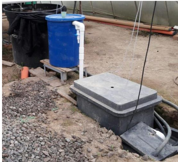
Figura 6. Sistema de filtración
