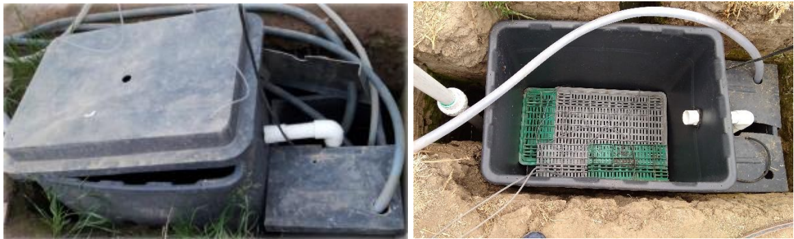
Figura 8. Biofiltro y sumidero
