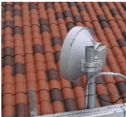
Antena y ODU Ericsson fijados al Mástil
