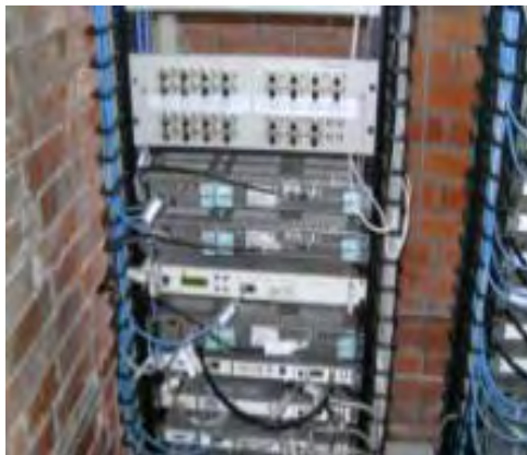
Vista general de los Racks de equipos
