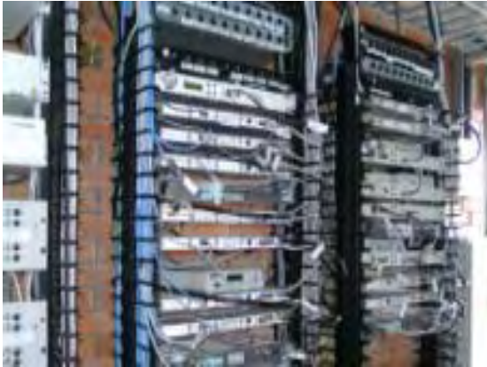
Vista general de los Racks de equipos
