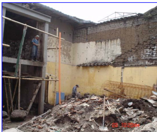
Figura N. 21 Demolición sin Licencia
