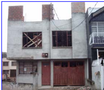
Figura N. 20 Construcción sin responsable de obra
