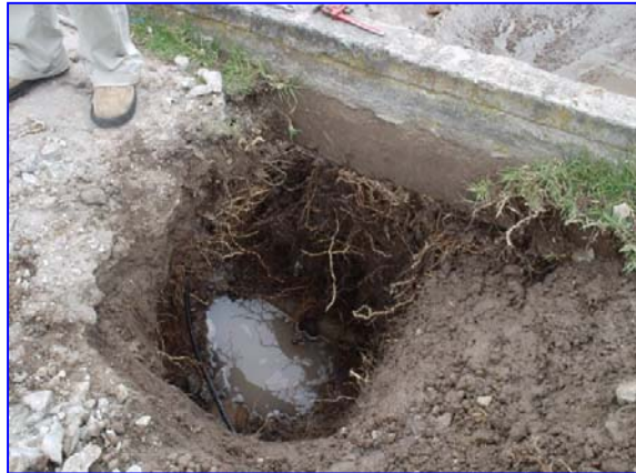
Figura N. 27 Rotura de calzada
