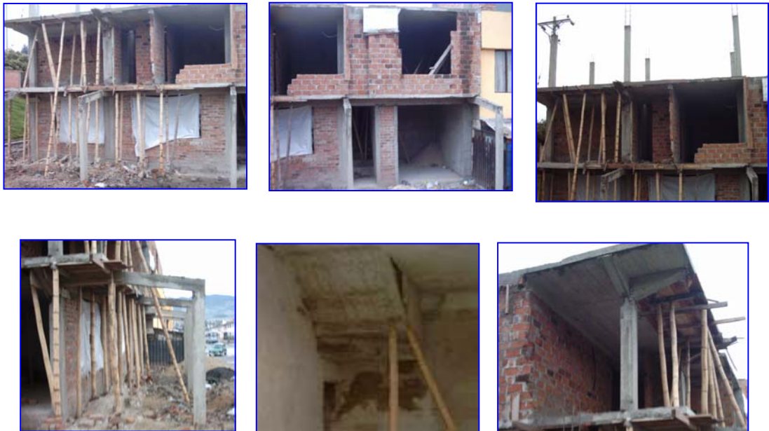
Figura N. 18 Construcción no ceñida a planos
