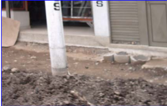
Figura N. 12 Andenes sin construir
