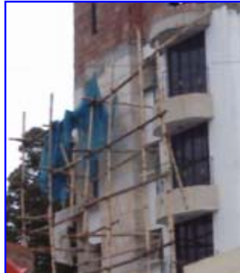
Figura N. 33 Construcción sin malla protectora
