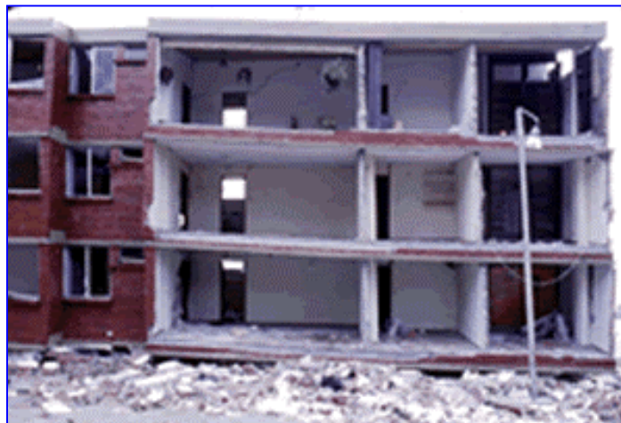
Figura N. 31 Inmueble en estado de ruina
