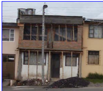
Figura N. 19 Construcción sin planos aprobados
