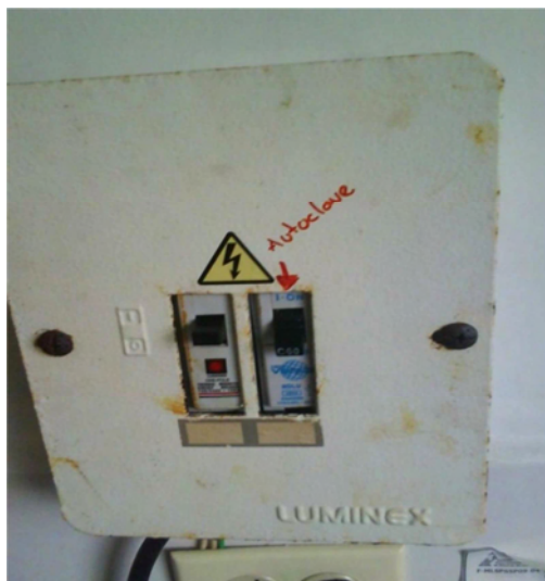
Figura 24. Breakers interruptores de corriente Tipo BR para conexión del Autoclave
