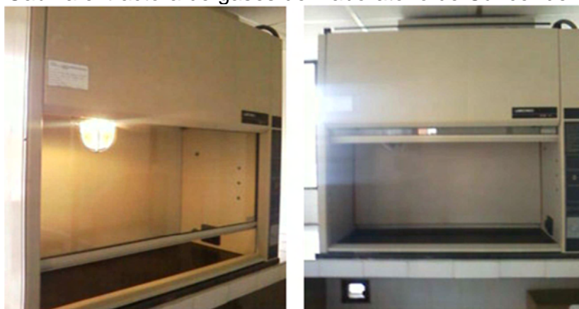
Figura 349. Cabina extractora de gases del Laboratorio de Cáncer de Cérvix
