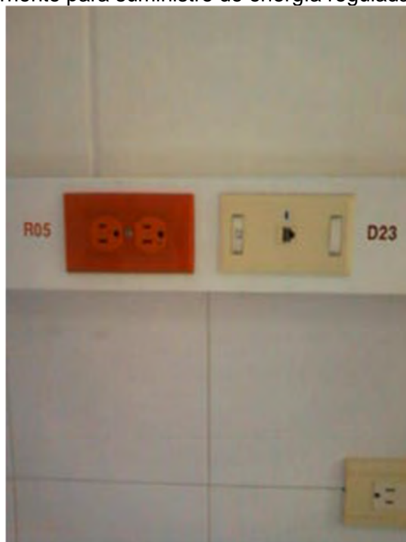
Figura 26. Tomacorriente para suministro de energía regulada y red de datos
