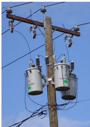
Fig. 9.29. Transformadores de distribución de energía eléctrica. Fuente: Fortyseven (s.f.).
