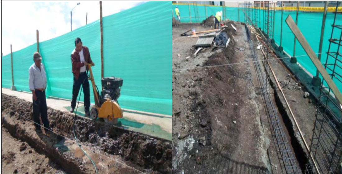
FOTO: 13 FOTO: 14 CORTE DE CONCRETO EXISTENTE PARA GRADERIAS ARMADO DE VIGA DE CIMENTACIÓN
