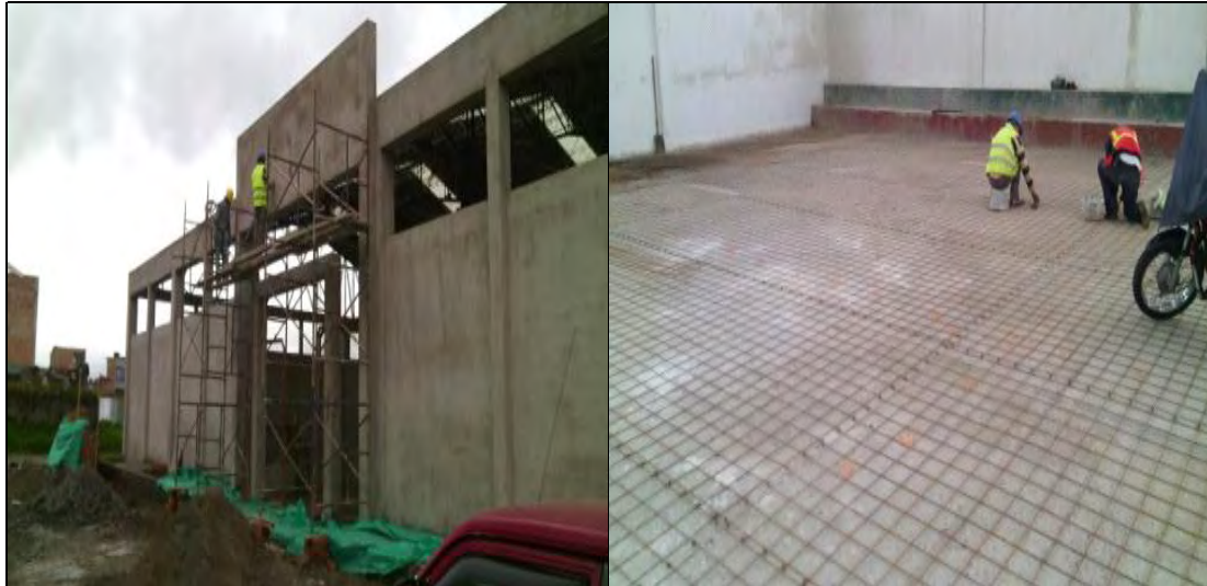
FOTO: 21 FOTO: 22 REPELLO LISO SOBRE FACHADA PRINCIPAL MALLA ELECTROSOLDADA N.7 PARA LOSA DE CANCHAS
