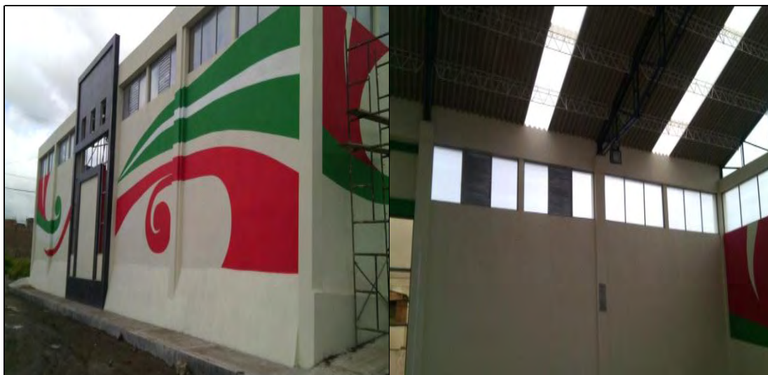
FOTO: 25 FOTO: 26 PINTURA DE FACHADA POSTERIOR INSTALACION DE TEJADOS TRASLUCIDOS Y VENTANERÍA
