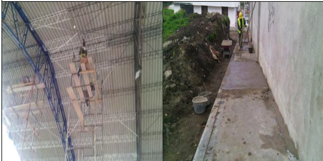
FOTO: 19 FOTO: 20 LIMPIEZA Y PINTURA DE ESTRUCTURA METÁLICA DE LA CUBIERTA CONSTRUCCIÓN DE ANDENES
