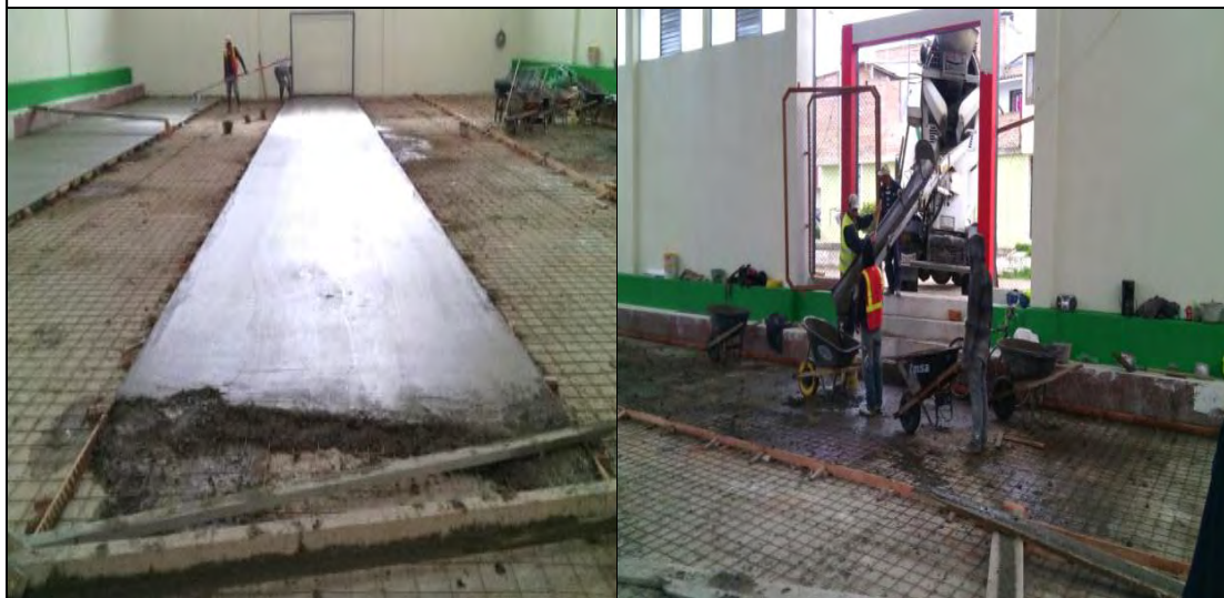
FOTO: 23 FOTO: 24 FUNDICIÓN DE LOSA DE CANCHA CONCRETO PREMEZCLADO PARA LOSA DE CANCHA
