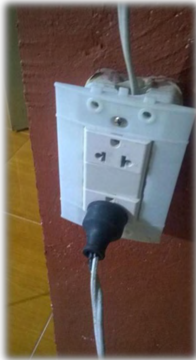
Figura 38. Tomacorriente sobre pared.
