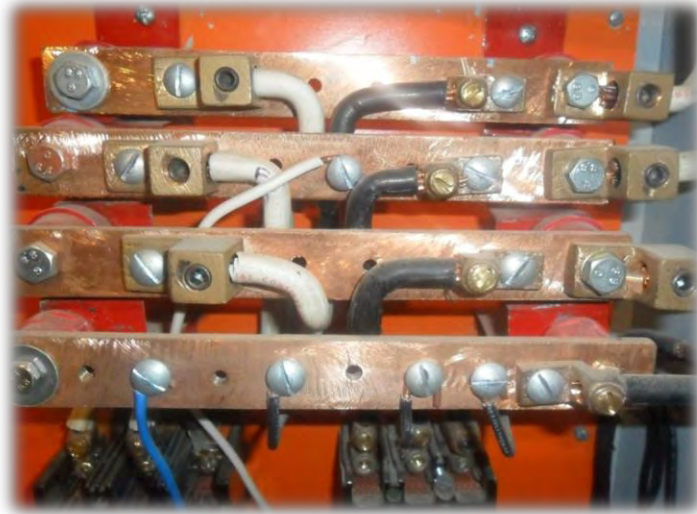
Figura 42. Tablero eléctrico cuarto de transmisores
