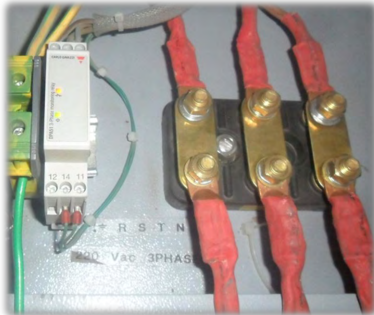
Figura 32. Nueva bornera de transmisor de FM.
