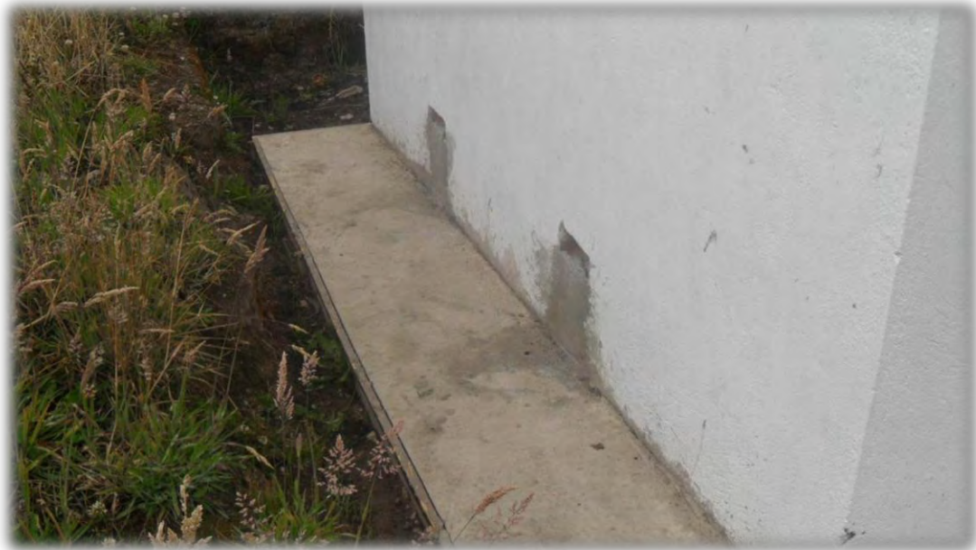
Figura 44. Protecciones cubiertas del cuarto de equipos
