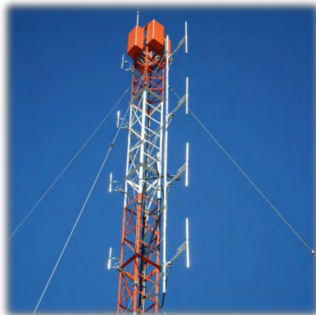
Figura 30. Pararrayos Torre de Transmisión
