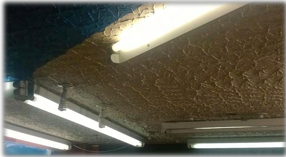
Figura 40. Cables a la vista.
