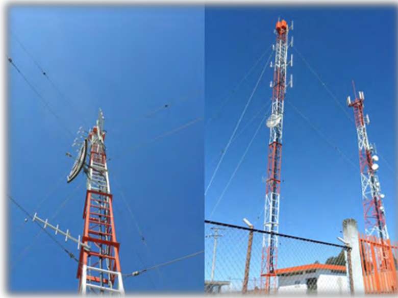
Figura 3. Torre de transmisión y cuarto de equipos
