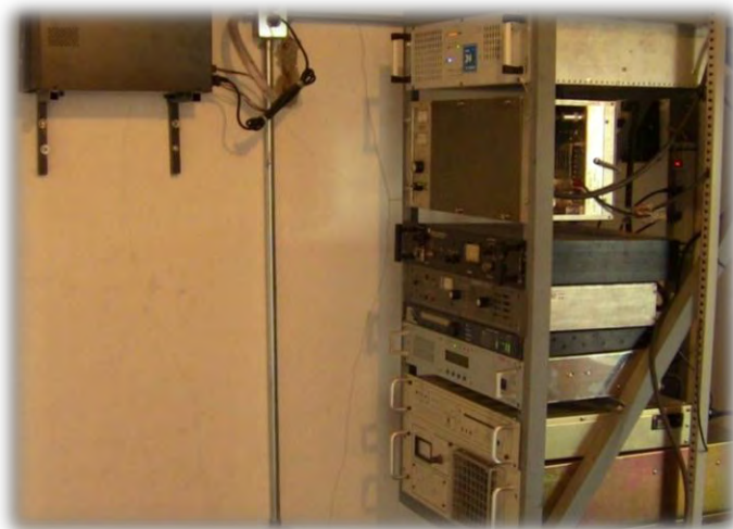
Figura 2. Cuarto de equipos en estudios
