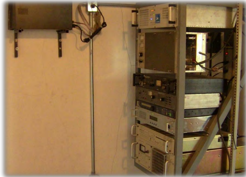
Figura 45. UPS cuarto de equipos del estudio
