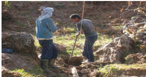
Figura 11. Tubería de conducción.
