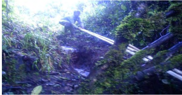
Figura 5. Tubería de conducción la Merced.
