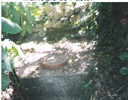
Figura 10. Bocatoma Aranda Pueblo. Municipio de Pasto.
