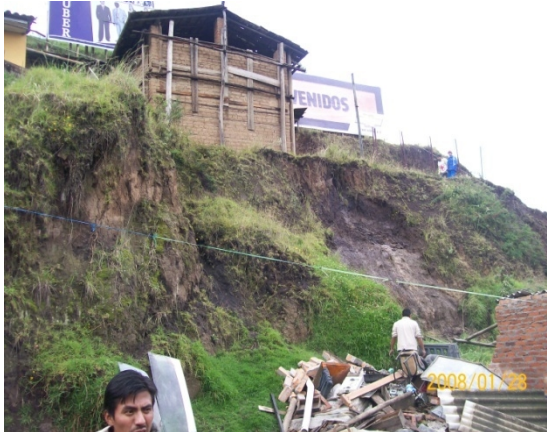
Fotografía 130. Deslizamiento de talud
