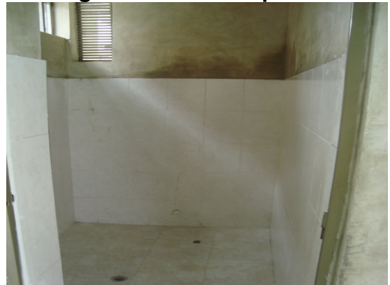
Fotografía 124. Enchape en baño
