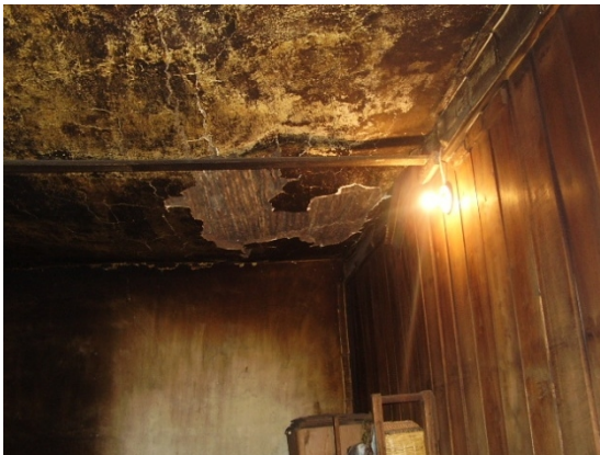
Fotografía 144. Cielo raso semidestruido
