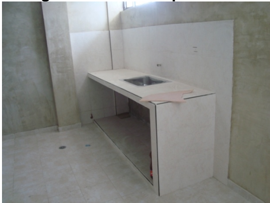
Fotografía 123. Enchape en cocina
