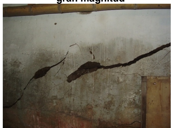
Fotografía 147. Detalle de fisuras de gran magnitud
