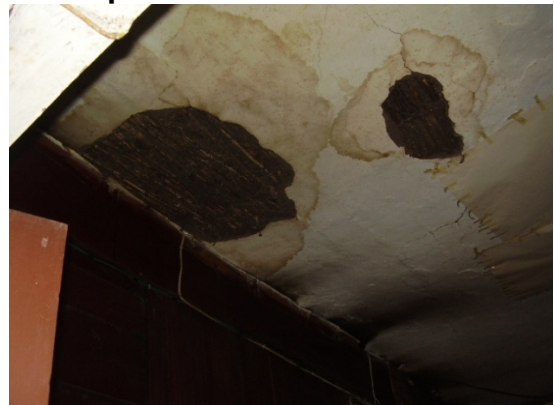
Fotografía 145. Cielo raso con presencia de humedad
