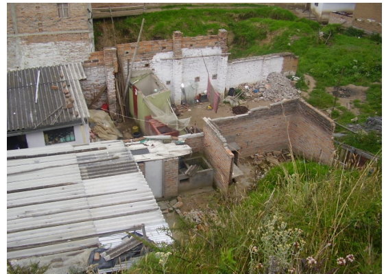
Fotografía 133. Vista superior de cocina destruida
