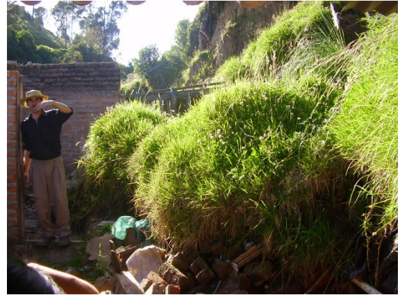
Fotografía 131. Afectación sobre construcción
