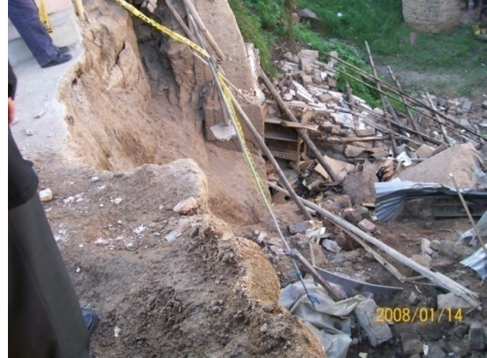
Fotografía 166. Talud y escombros sobre lote vecino
