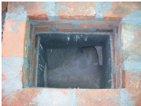
Fotografía 91. Caja de Inspección 0.60x0.60 m
