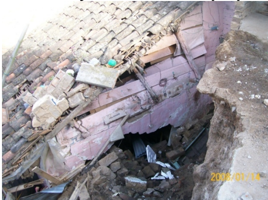
Fotografía 167. Vivienda adyacente afectada propiedad Eduardo Tapia
