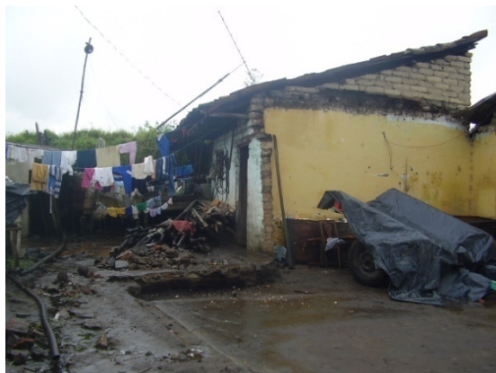
Fotografía 161. Contrapiso casa destruida
