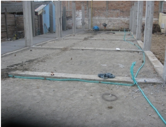
Fotografía 39. Instalación eléctrica primer piso
