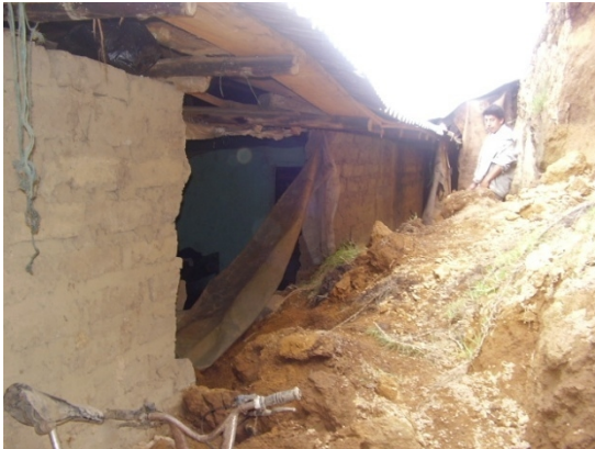
Fotografía 153. Muro colapsado por Talud
