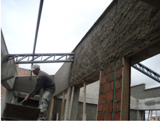
Fotografía 70. Pañete sobre muro
