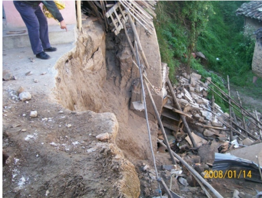
Fotografía 165. Patio colapsado propiedad de Zoila B.
