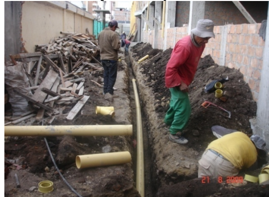
Fotografía 68. Conexión tubería ALL con caja de inspección
