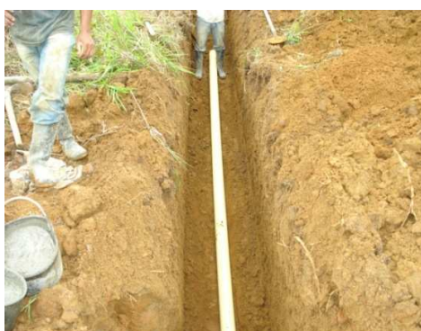
Fig. 55 Instalación particular de tubería de 8”
