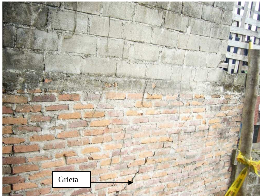
Fig. 16 Grieta en pared lado colindante
