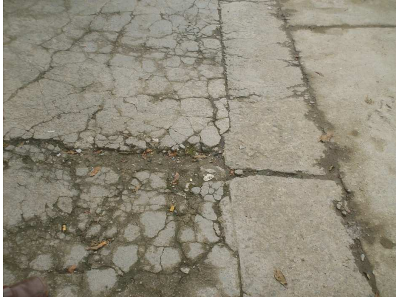
Fig. 11 Superficie en mal estado, falla tipo piel de cocodrilo
