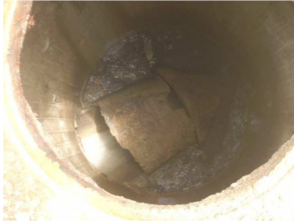
Fig. 5 Tubería en mal estado
